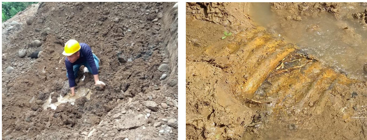
Figura 7: Filtración y raíz en la alcantarilla K0+360
