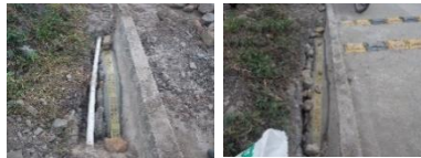
Ilustración 30. Protecciones en concreto.
