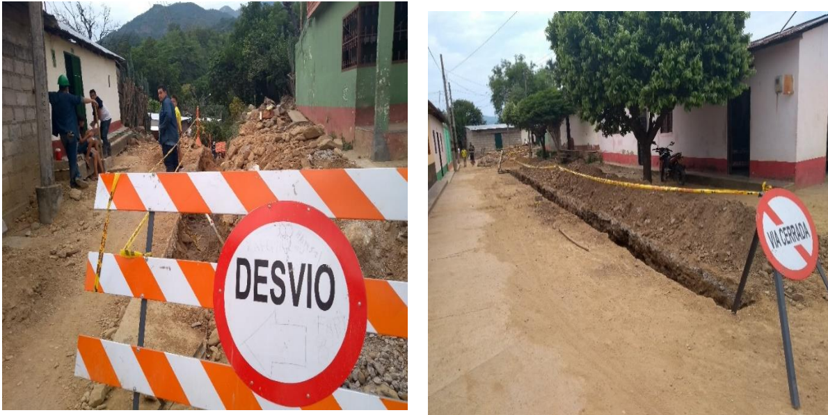
Figura 26. Señalizaciones Preventivas de todos los tramos intervenidos
