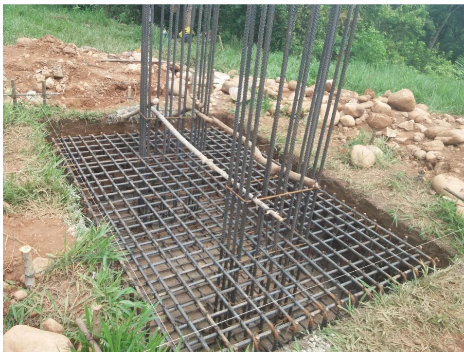
Figura 22: Amarre de acero zapata torre, zona dos (Fuente: Autor)
