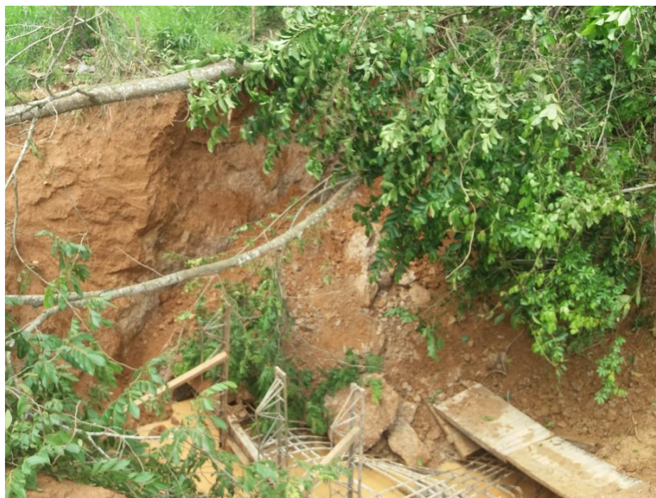
Figura 33: Continuación de deslizamientos de tierra sobre el muerto de la zona dos (Fuente: Autor)
