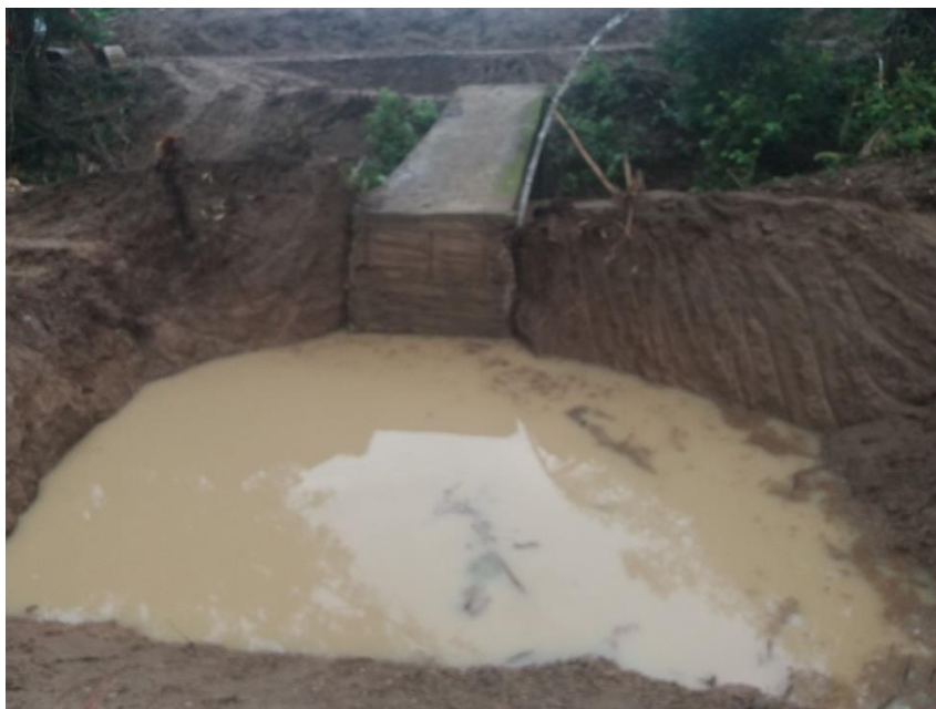
Figura 68: Infiltración en excavaciones (Fuente: Autor)
