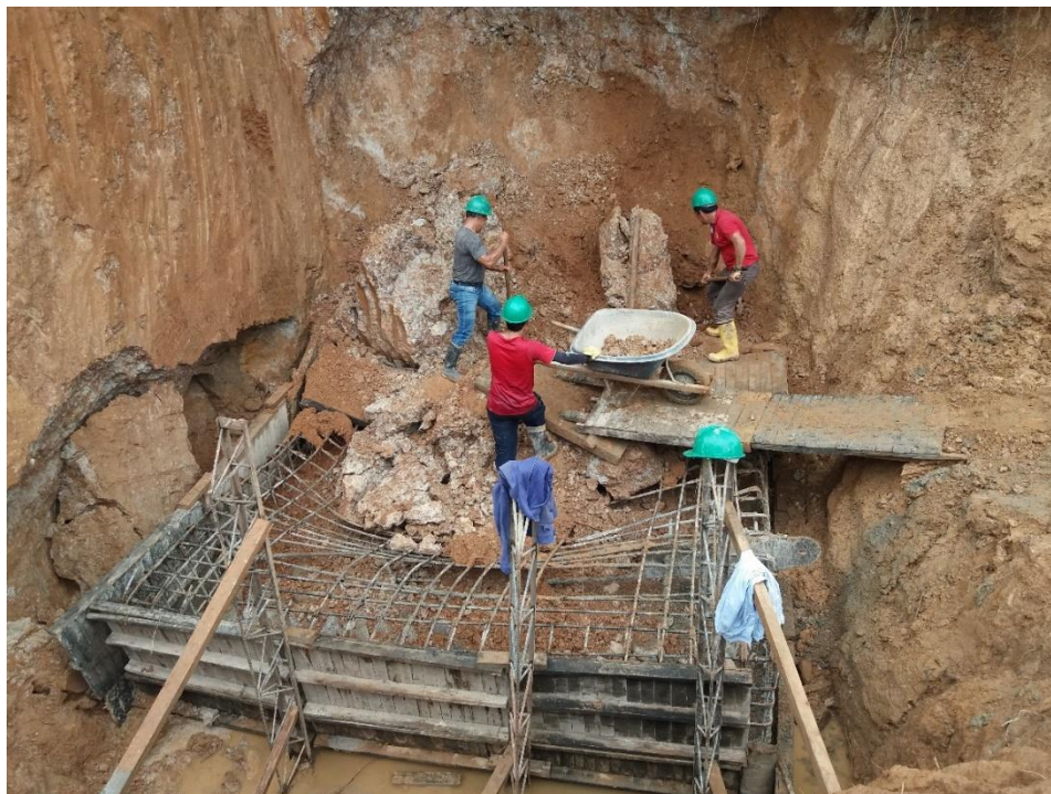
Figura 32: Derrumbe de las paredes de la excavación sobre el muerto de la zona dos (Fuente: Autor)
