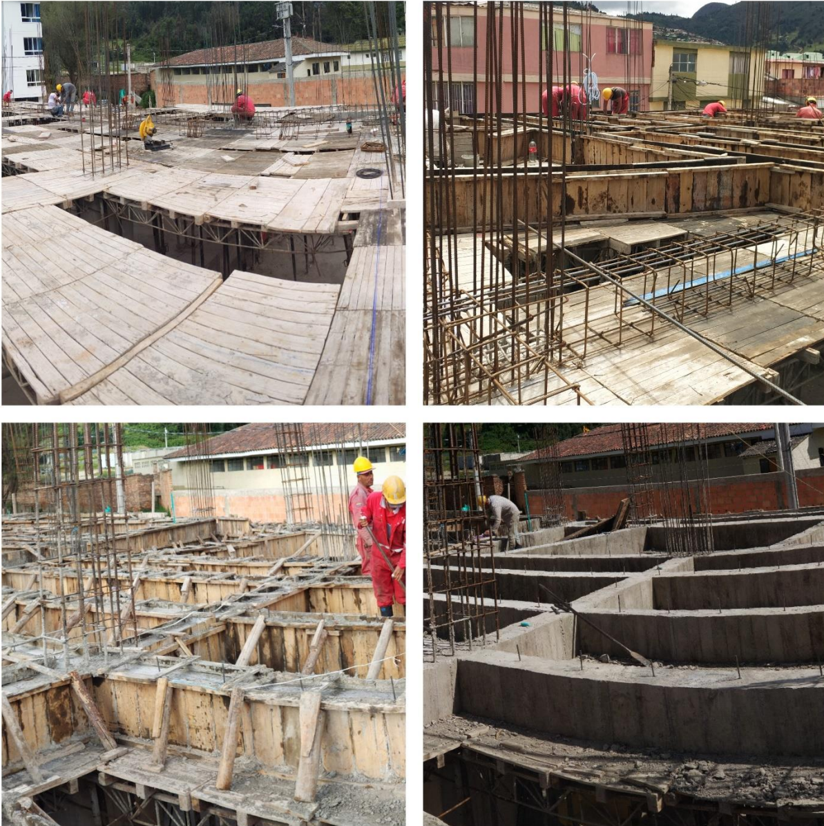
Ilustración 19 Armado cama de vigas, colocación de acero y formaleta y posterior fundida.
