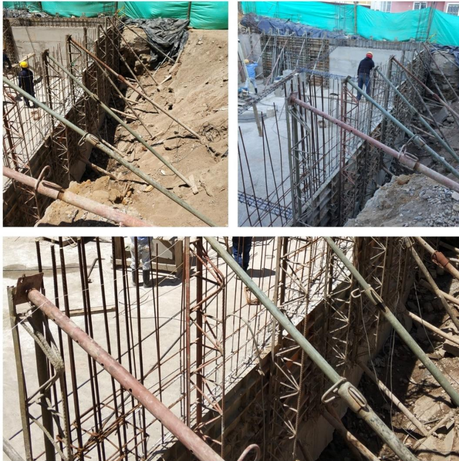
Ilustración 9 Fuente Autor. Estado de los muros pantalla al iniciar la pasantía.
