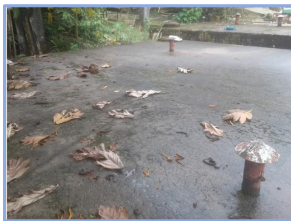
Foto 102. Tanques de almacenamiento-El porvenir
