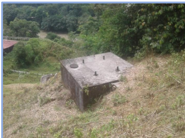
Foto 97. Tanque de almacenamiento funcional-Brisas de río Mocoa.
