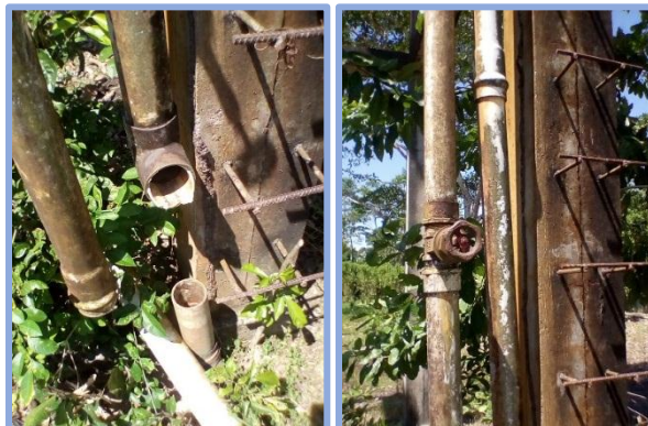
Foto 138. Tubería de conducción de 3"-Puerto Rosario
