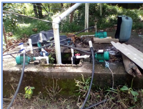
Foto 156. Suministro por pozo profundo-José María
