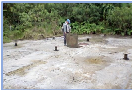
Foto 126. Tanque de Almacenamiento-Veredas de San Francisco
