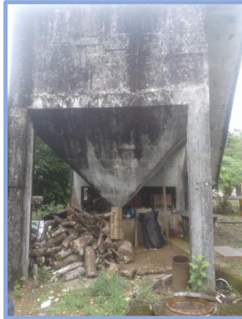
Foto 101. Planta de tratamiento-El porvenir
