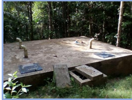
Foto 105. Tanque de almacenamiento-Medio Afan
