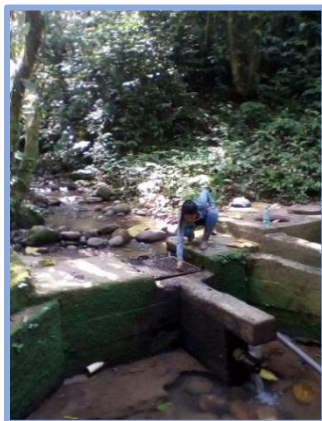
Foto 140. Bocatoma quebrada la Toroyaco-El Jauno y el Muelle
