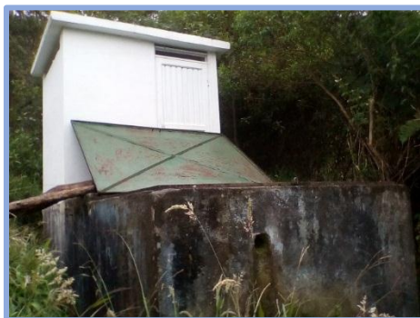
Foto 135. Ubicación Tanque de Almacenamiento-Balsayaco
