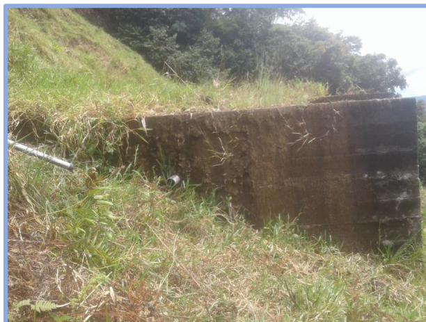
Foto 98. Tanque de almacenamiento abandonado-Brisas de río Mocoa
