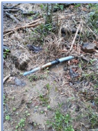
Foto 93. Línea de conducción con ruptura-Bajo corazón
