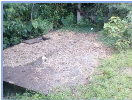
Foto 144. Tanque de almacenamiento subterráneo-El Recreo
