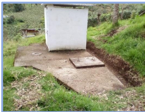
Foto 133. Tanque de almacenamiento-Tamauca Viejo y Cabildo Inga
