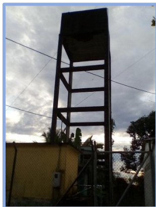
Foto 147. Tanque elevado de almacenamiento-Mayoyoque
