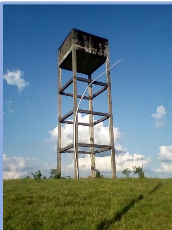
Foto 145. Tanque elevado de almacenamiento-El Recreo
