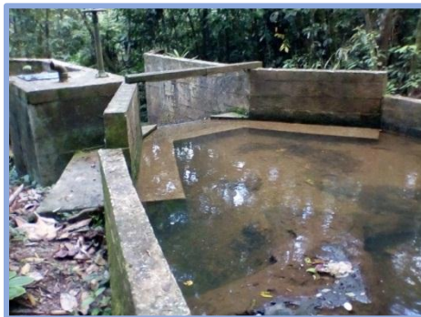
Foto 103. Estructura de captación-Medio Afan.
