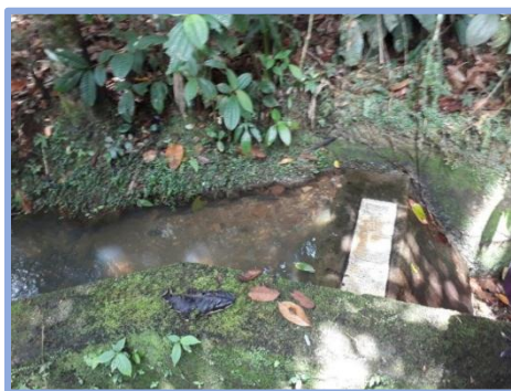
Foto 111. Estructura de captación-San José del Pepino
