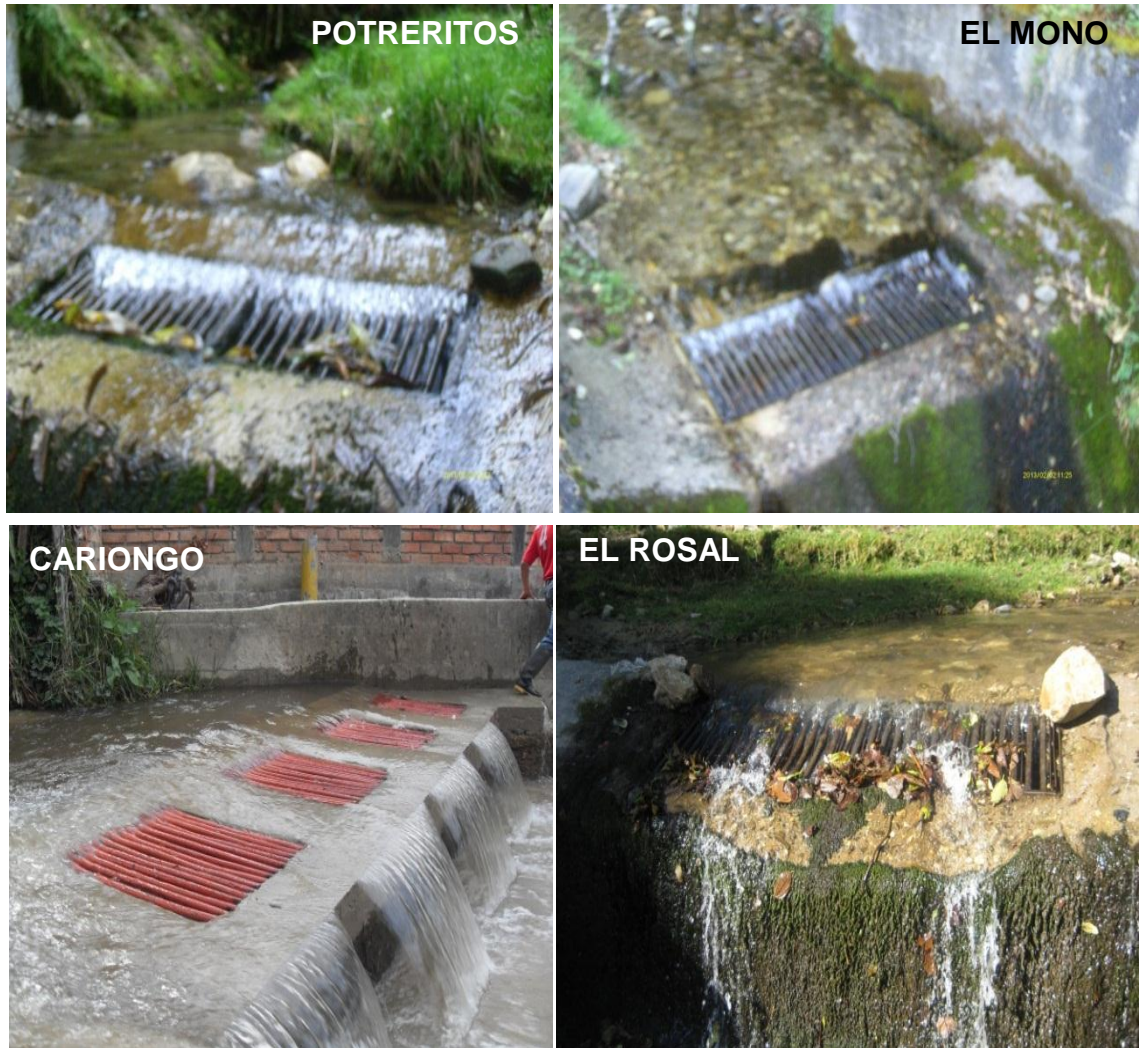
Figura 5. Sistemas de captación del acueducto EMPOPAMPLONA
