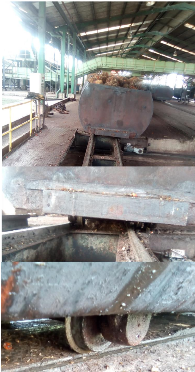
Figura 12. Descarrilamiento de vagonetas, Fuente: Palmicultores del Norte S.A.S (2019)
