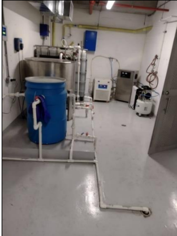
Figura 19. Fotografía del proceso de ozonización instalado en el Centro Médico Imbanaco.
