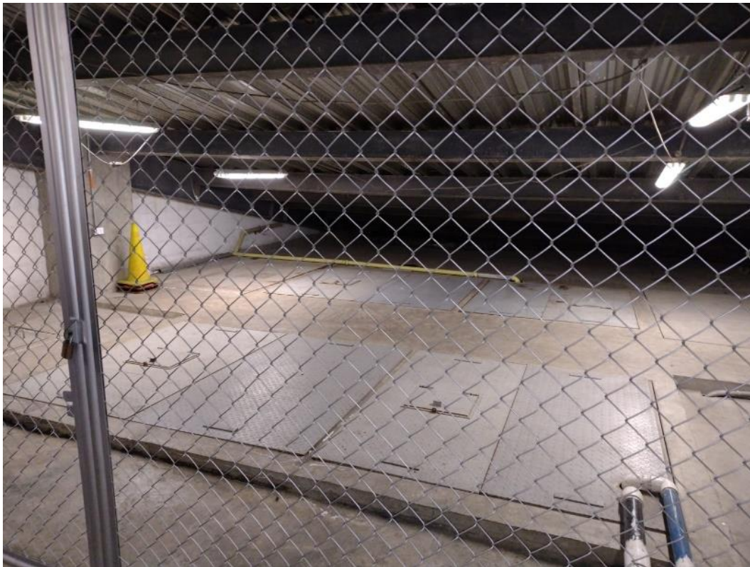
Figura A4. Fotografía del tanque de almacenamiento del sótano 4.
