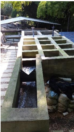
Figura 13. Canaleta Parshall y Floculador Tipo Alabama
