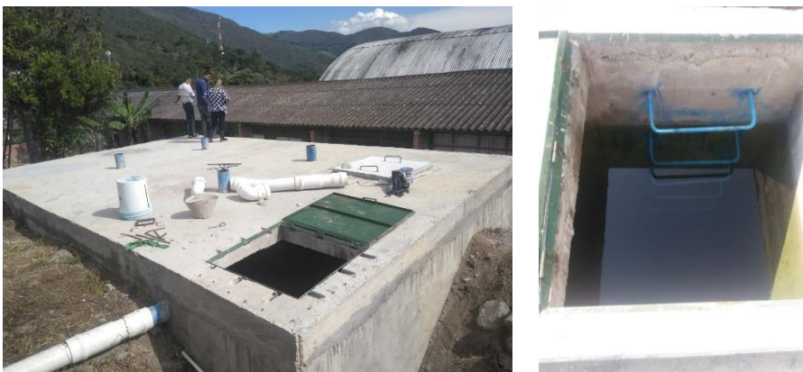
Figura 20. Tanque de Almacenamiento Nuevo
