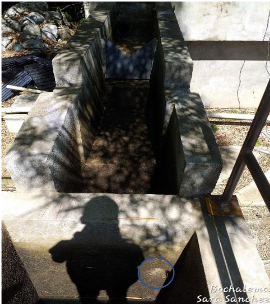
Figura 22. Ingreso de Agua a la Primera Cámara del Floculador
