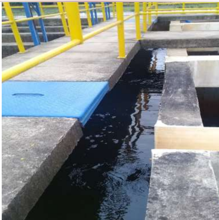
Canal de recolección de agua clarificada
