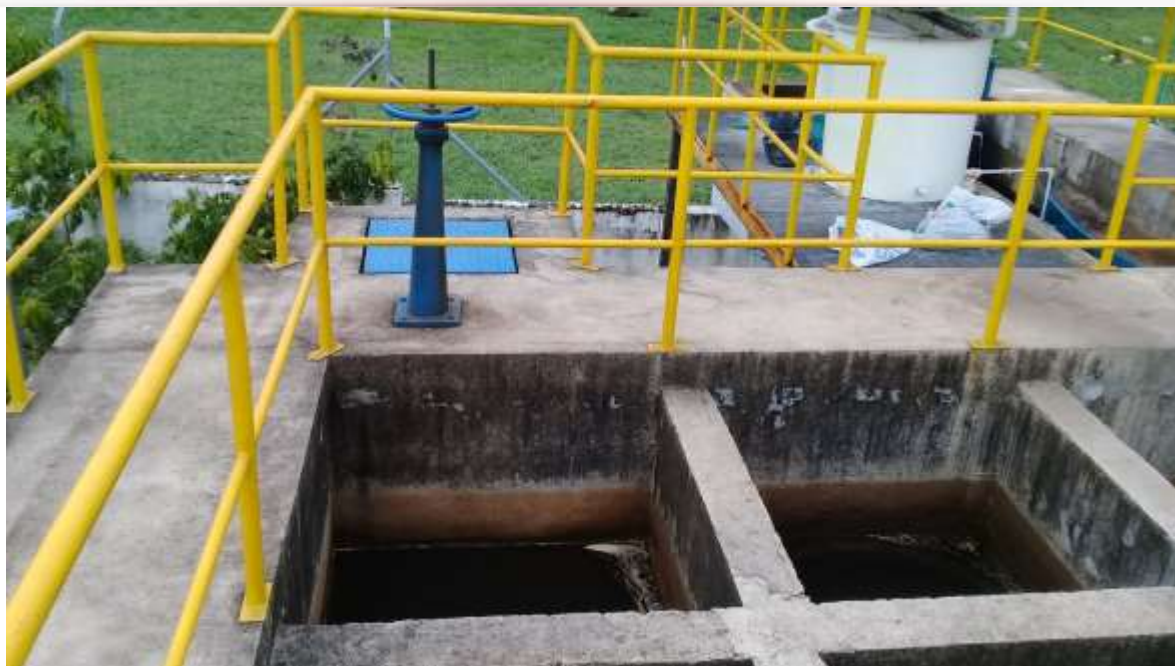
Válvula de entrada flocculador derecho
