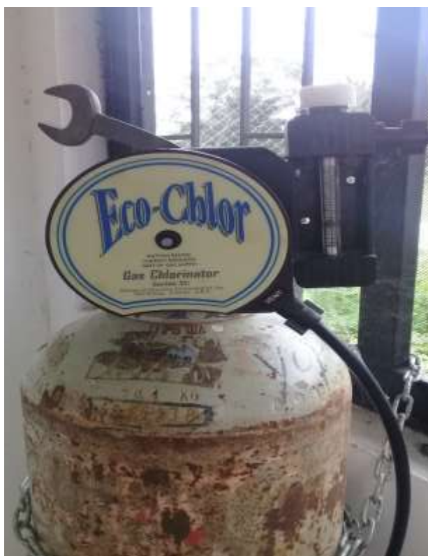
Dosificador de cloro
