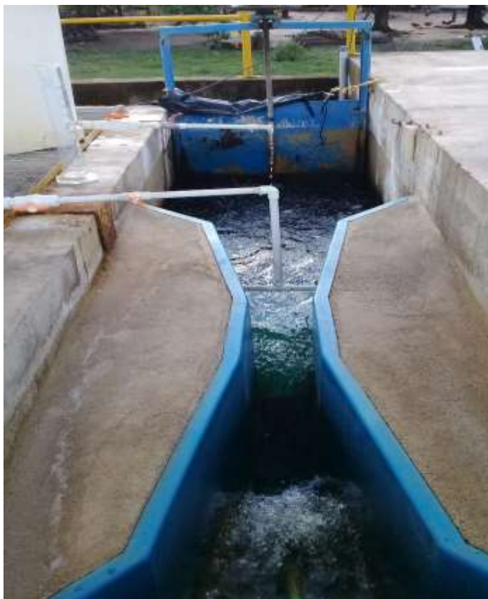
Canaleta parshall- resalto hidráulico- Dosificación de sustancias
