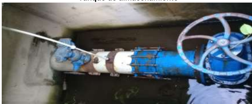
Válvula de salida del tanque de almacenamiento
