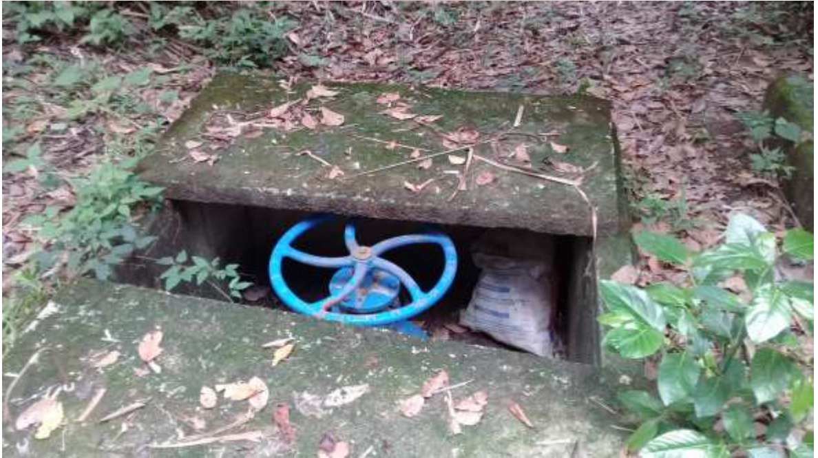
Válvula de control (Captación-desarenador)
