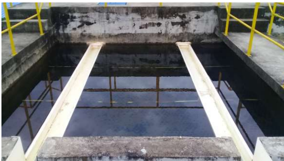
Canaletas de recolección de agua clarificada- Floculador derecho
