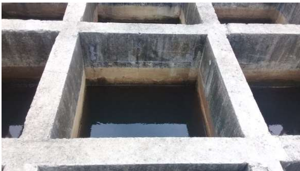
Cámara de floculación
