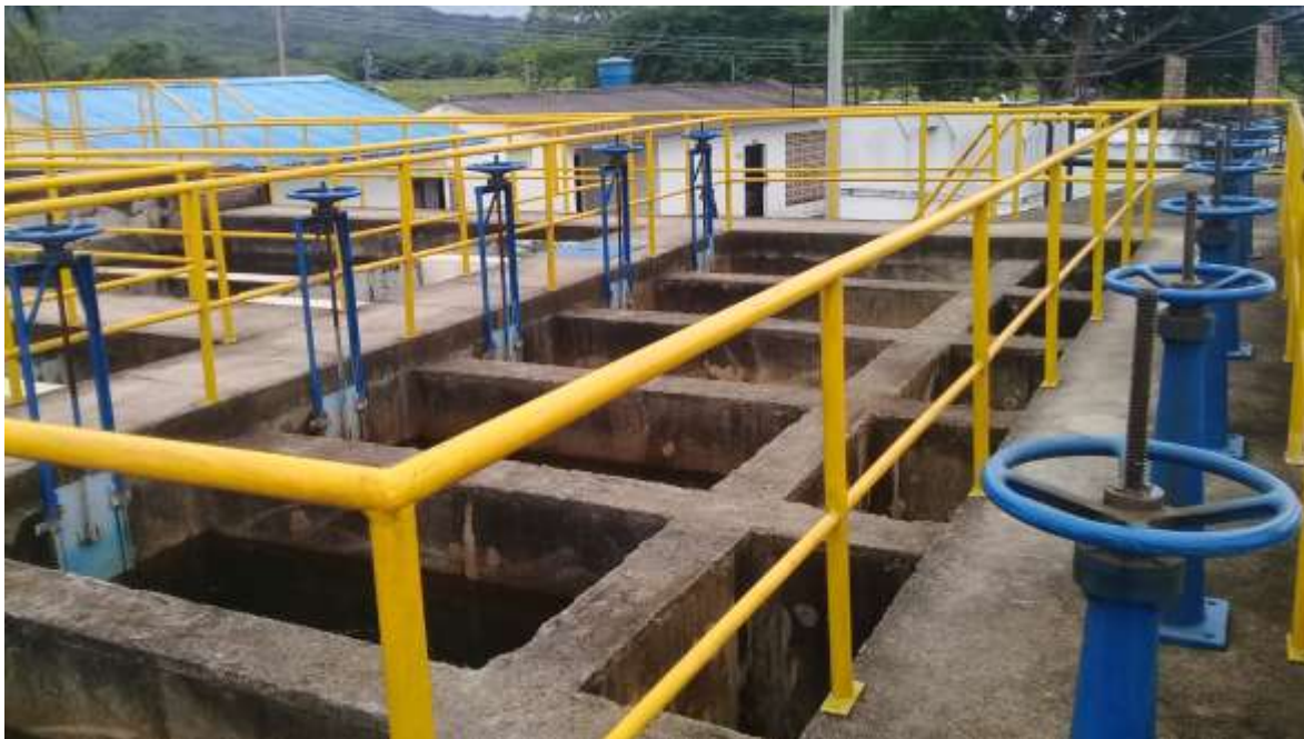
Batería de filtros
