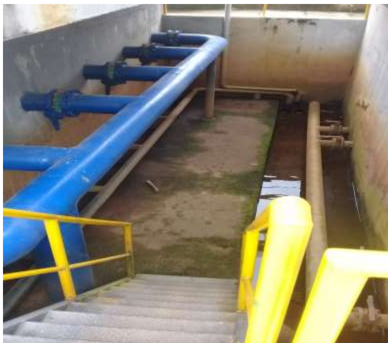
Válvulas de lavado de filtros
