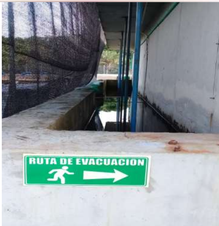
Tanque de equilibrio- recolección de agua filtrada
