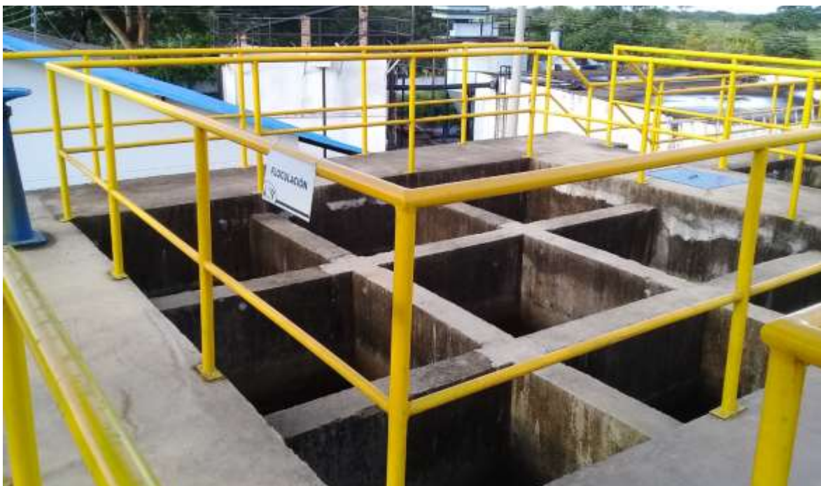
Floculador hidráulico izquierdo
