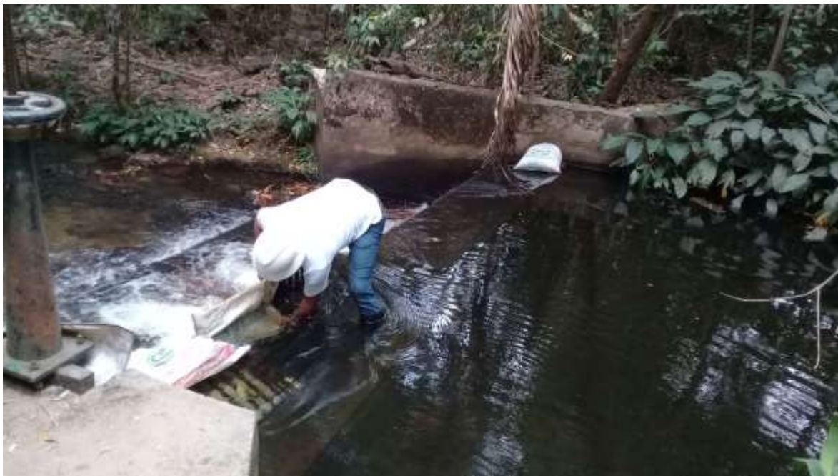
Rejilla de captación
