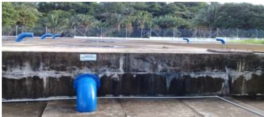
Tanque de almacenamiento
