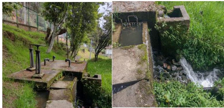
Figura 8. Cámara de empalme.
