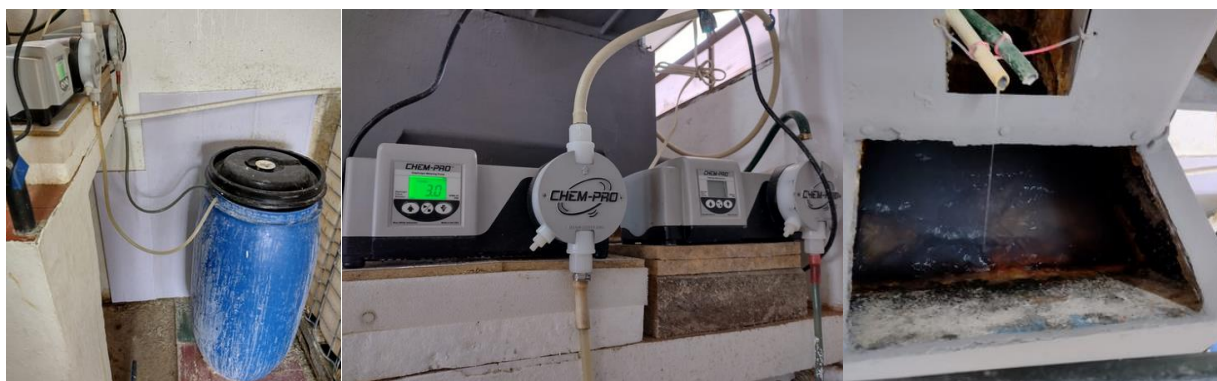
Figura 11. Equipo de dosificación de coagulante.
