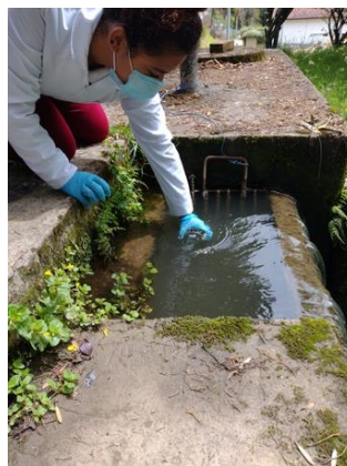
Cámara de empalme
