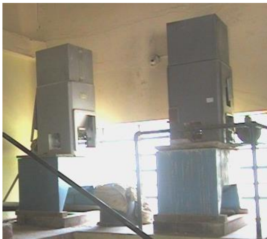
Figura 17. Unidad de dosificación que anteriormente se utilizaba
