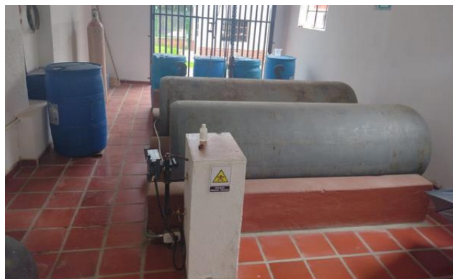
Figura 16. Unidad de desinfección.
