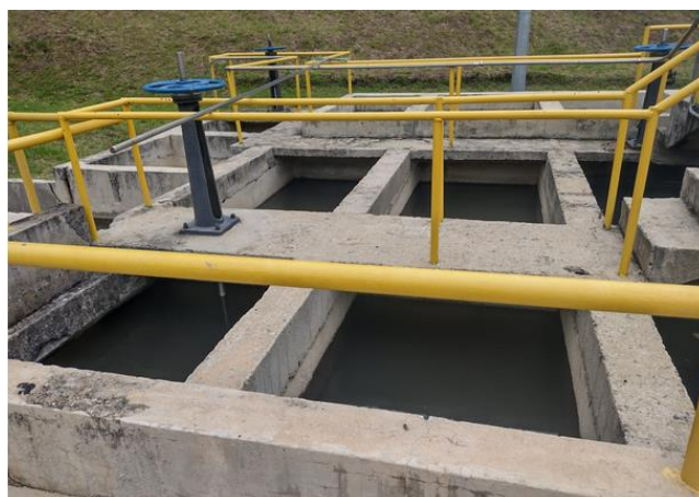
Figura 12. Unidad de floculación.
