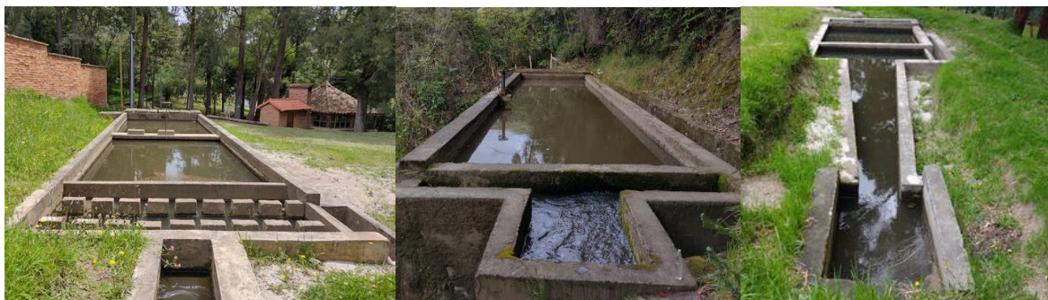
Figura 6. Estructura de desarenado.
