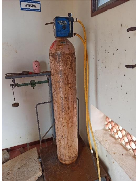
Figura 14. Cilindro de cloro y dosificador de cloro planta Santa Lucía (Autor).
