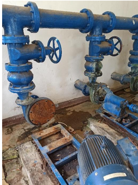
Figura 26. Sistema de bombeo planta Casa de Teja (Autor).
