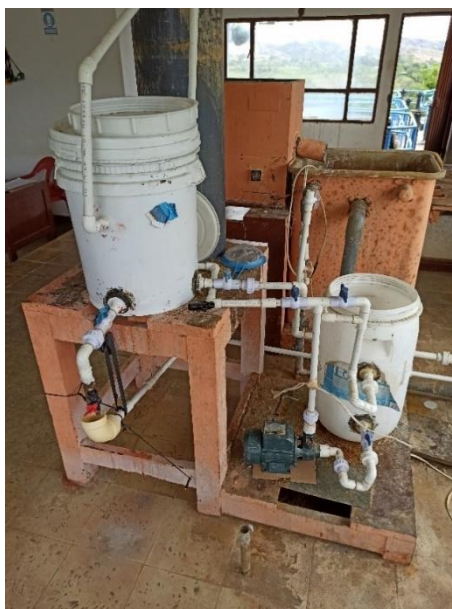
Figura 20. Dosificador de cloruro de polialuminio planta Casa de Teja (Autor).
