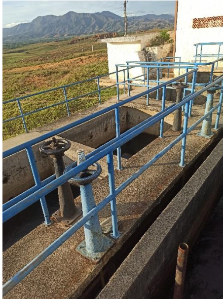
Figura 13. Unidades de filtración planta Santa Lucía (Autor).
