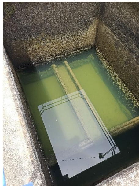
Figura 24. Unidad de filtración de alta tasa planta Casa de Teja (Autor).
