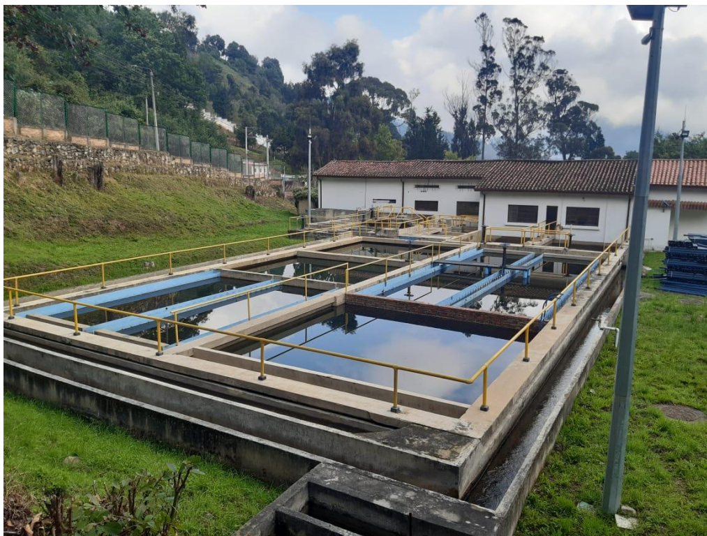
Figura 4. Planta de tratamiento de agua potable Cariongo
