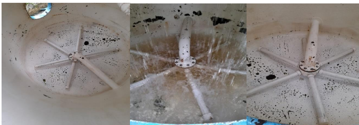
Figura 28 Limpieza y desinfección de cada una de las columnas de intercambio iónico
