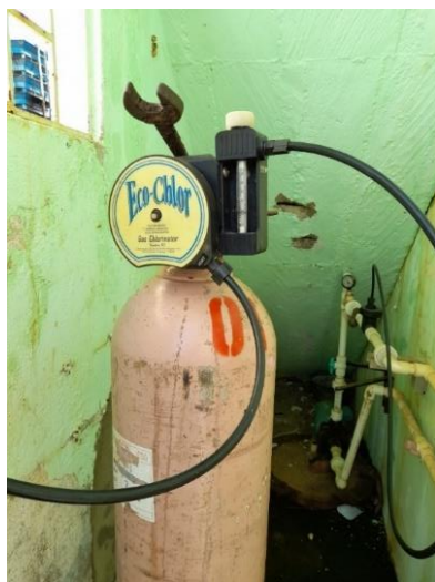
Figura 16 Unidad de desinfección con cloro gaseoso
