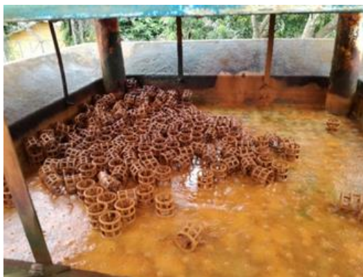
Figura 5 Estado actual de las bandejas de la torre de aireación
