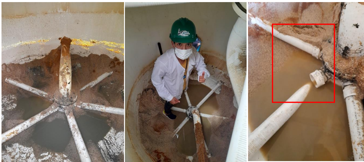
Figura 25 Identificación de la flauta con defectos de instalación en el intercambiador 1.
