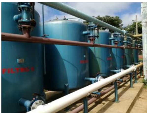
Figura 14 Unidades de filtración del tratamiento de agua potable
