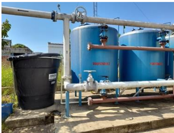
Figura 15 Intercambiadores iónicos con su tanque de preparación de solución para la regeneración de resina
