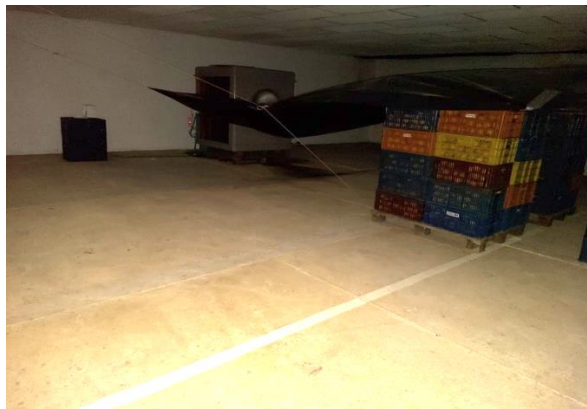
Figura 9. Transporte del aire producido por el enfriador evaporativo sobre las canastas de toronja.
