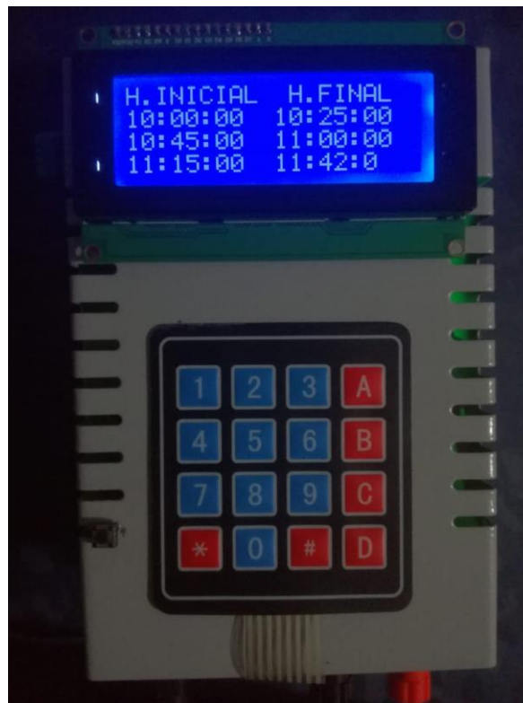
Ilustración 61. Vista frontal del controlador. Fuente: Autor.
