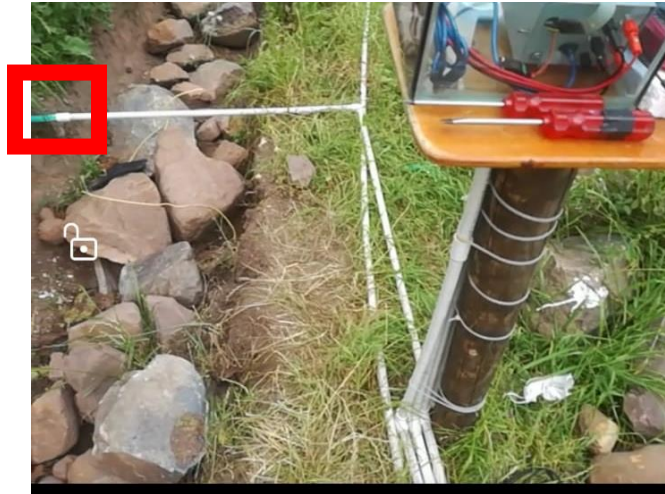
Ilustración 74. Punto de alimentación eléctrica. Fuente: Autor.
