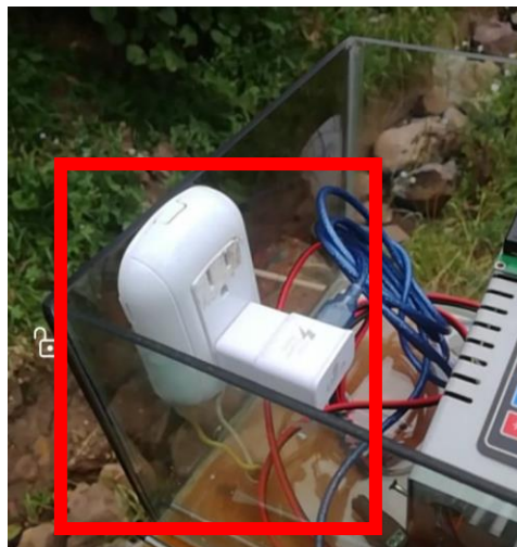
Ilustración 75. Instalación eléctrica; electroválvulas – controlador. Fuente: Autor.
