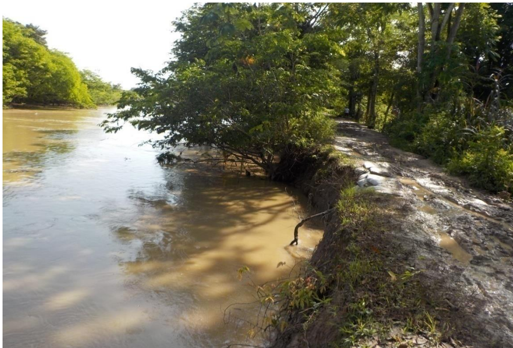
Ilustración 10 Fenómenos de erosión y pérdida de talud en la zona de influencia
