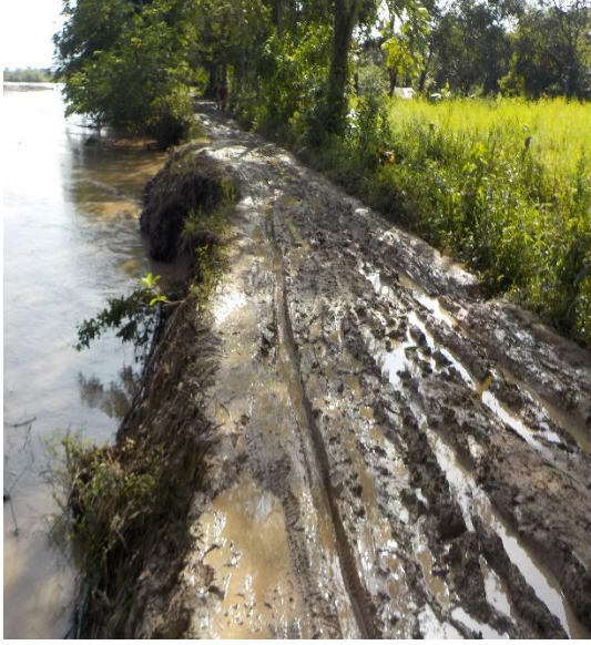
Ilustración 11 Caída de banca de la vía
