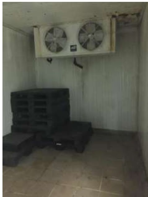
Figura 36. Cuarto frío antes de la implementación.
