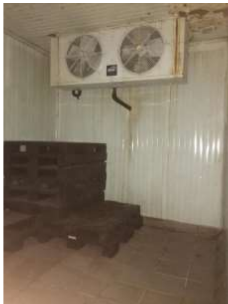
Figura 17. Cuarto frío para almacenamiento.
