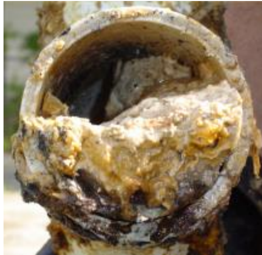
Figura 1. Obstrucción de tuberías por aceites y grasas.
