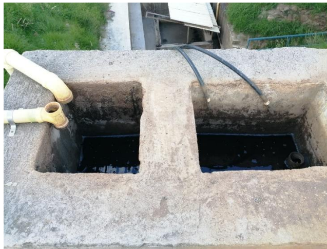
Figura 5. Fosa de lixiviado. [Imagen] Autor: propio.
