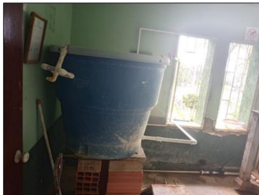
Ilustración 24 Bases de tanques inadecuadas, no se cuenta con bases sólidas necesarias para
