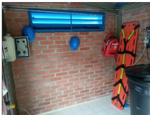
Ilustración 18 Falta implementos primeros auxilios ,no se cuenta con extintor en caso de una emergencia por fuego.
