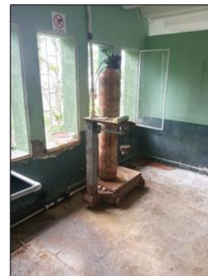
Ilustración 22 Pipetas de oxígeno en mal estado, que pueden provocar graves accidentes.
