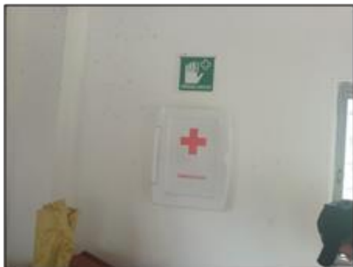
Ilustración 19 Falta de implementos de primeros auxilios, el botiquín no cuenta con la dotación completa recomendada.
