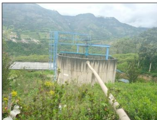
Ilustración 13 Alta vegetación que cubre tubería de la unidad de aguas residuales.
