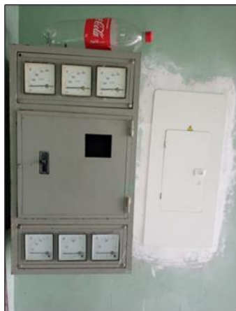
Ilustración 16 Falta señalización, no se cuenta con las señales de peligro en la fuentes de tableros de circuitos
