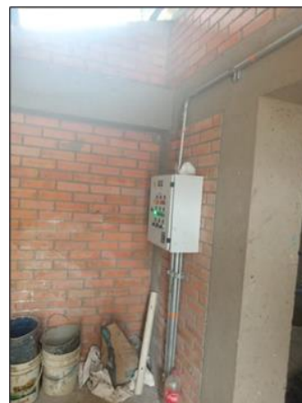
Ilustración 15 Falta señalización en los tableros de control.
