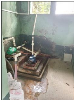
Ilustración 23 Equipos en mal estado desgastados por la corrosión o paso del tiempo
