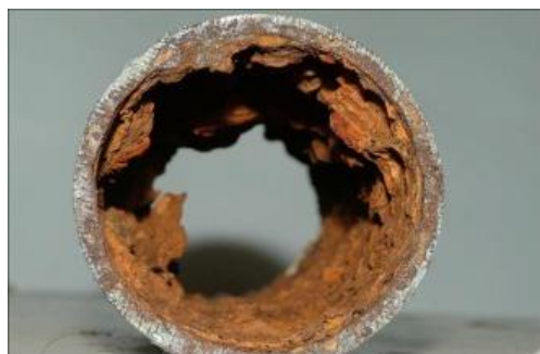
Figura 3. Tubería afectada por corrosión MIC.
