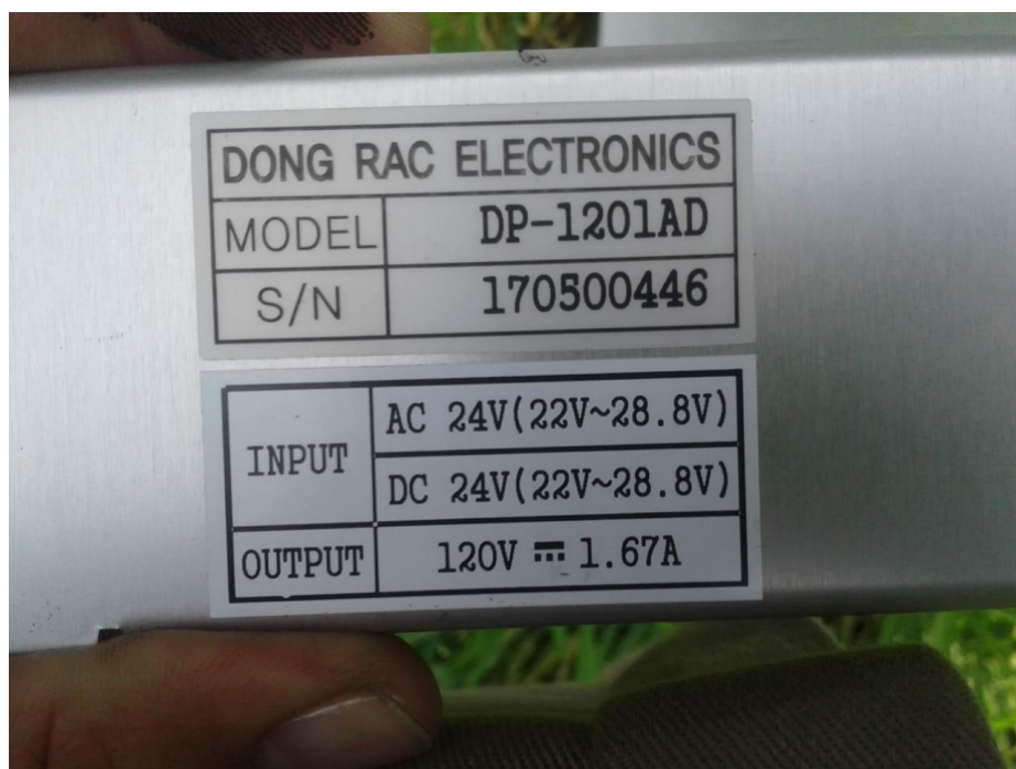
Ilustración 40. Tensión de alimentación en un reconector ENTEC.
