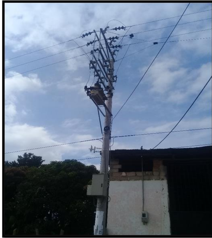
Ilustración 44. Reconector RC105 en poste.
