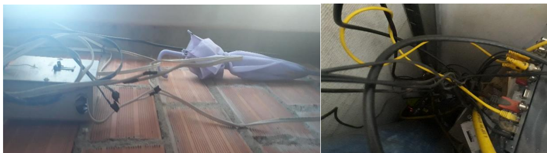
Figura 3-3. Conexiones eléctricas en mal estado Fuente: Elaboración propia
