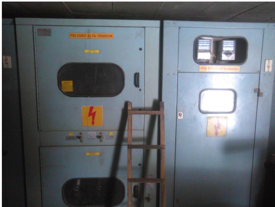
IMAGEN 1. Subestación eléctrica del complejo penitenciario y carcelario metropolitano de Cúcuta.
