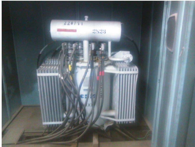
IMAGEN 5. Transformador eléctrico de 400 KVA ubicado en la subestación eléctrica del complejo penitenciario y metropolitano de Cúcuta.
