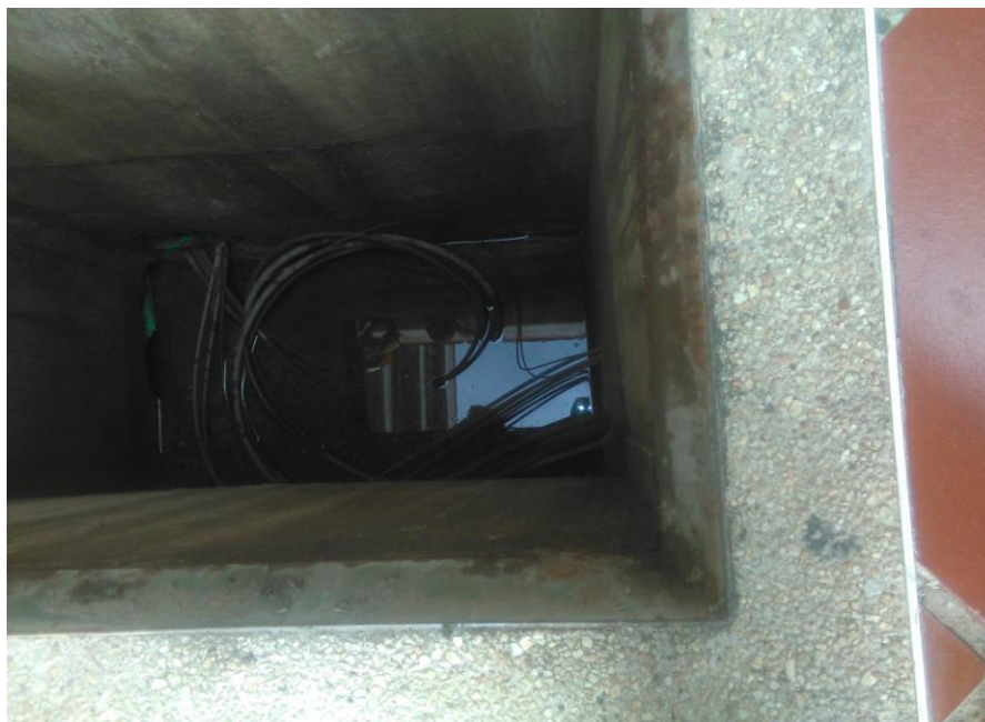
IMAGEN 2. Visualización del estado de las acometidas subterráneas del (COCUC)
