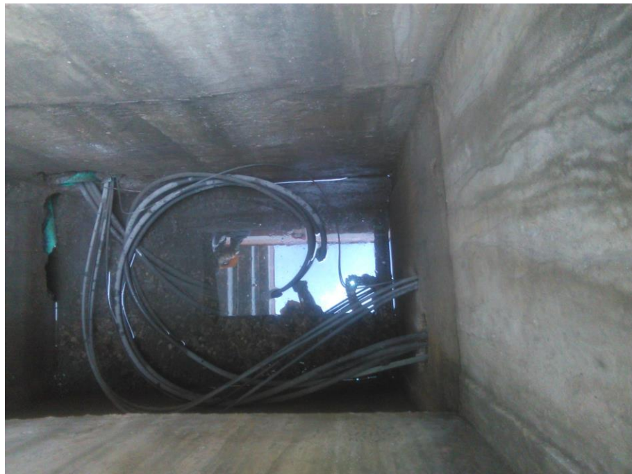
IMAGEN 6. Visualización e inspección de caja eléctrica la cual se evidencia la existencia de agua que cubren el sistema de cableado eléctrico.
