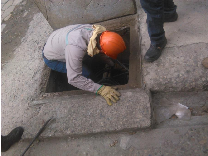
IMAGEN 3 revisión de las cajas eléctricas por parte de personal capacitado de las centrales eléctricas de norte de Santander (CENS)
