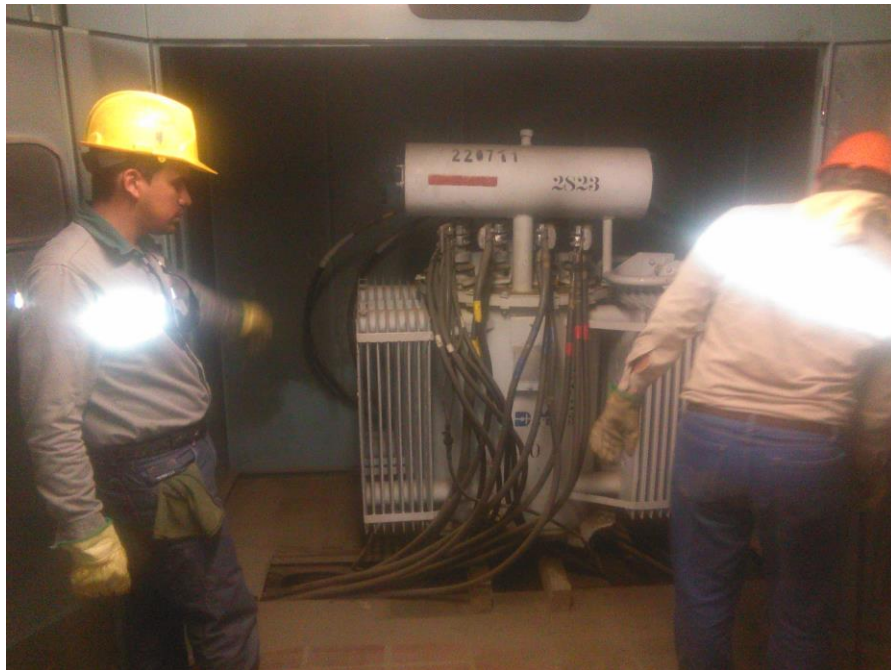
IMAGEN 4. Revisión a unos de los transformadores de 400 KVA. Del (COCUC)
