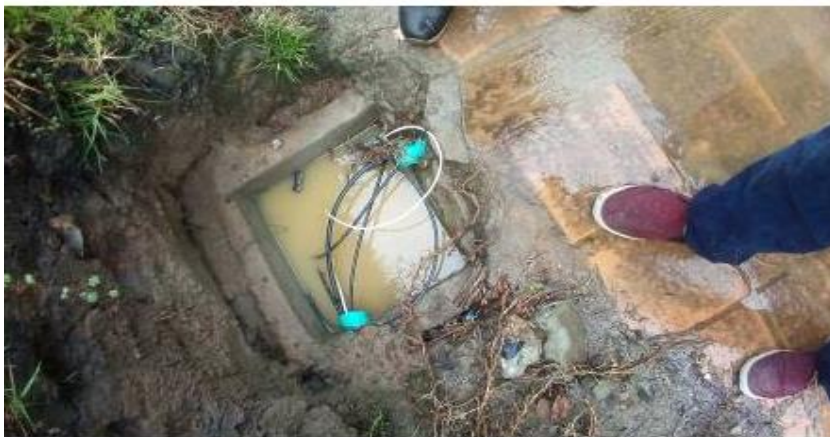
Figura 50. Cajas existentes por donde pasa la fibra óptica.
