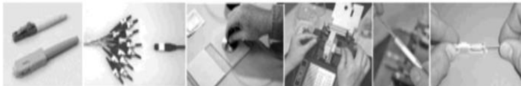
Figura 17. Empalme de fibra óptica
