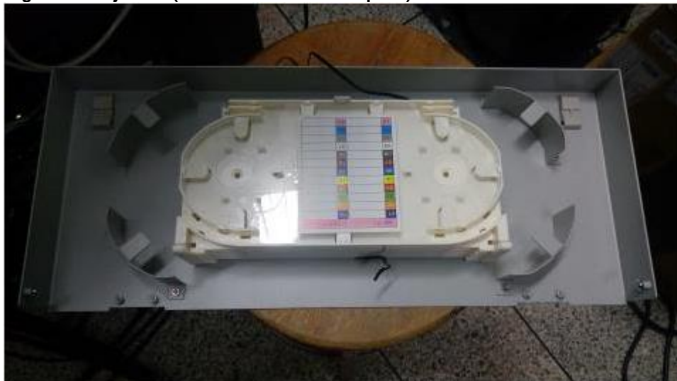
Figura 25. Caja ODF (Distribución de Fibra Óptica).
