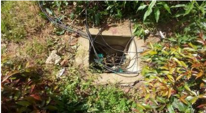
Figura 49. Revisión de las cajas por donde existe el tendido de la fibra óptica.
