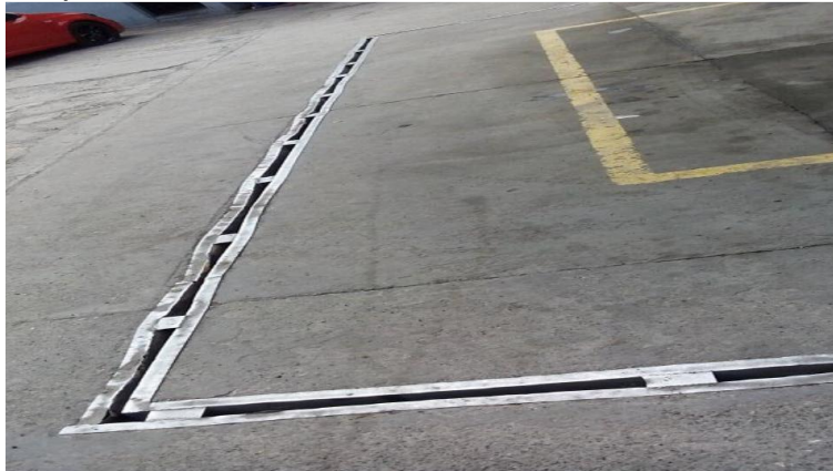
Figura 2. Canales perimetrales de la isla de servicio
