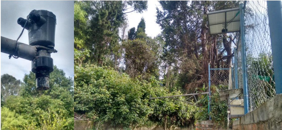
Figura 50. Estación de medición de caudal Empopamplona.
