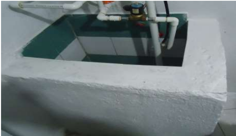
Figura 31. Foto del tanque de reserva. Fuente: Foto tomada por el autor.
