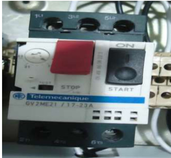
Figura 23. Foto del guarda motor GV2ME21. Fuente: Foto tomada por el autor.
