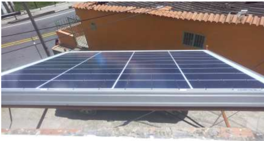
Figura 33. Panel solar policristalino 55w. Fuente: Foto tomada por el autor.
