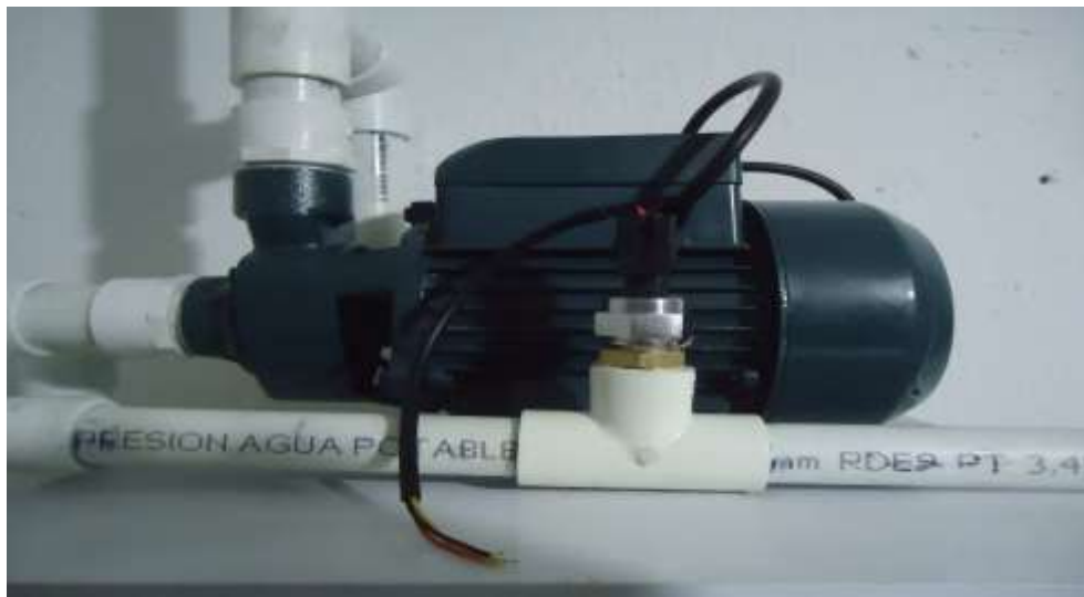
Figura 30 .Foto de Bomba periférica (QB 60). Fuente: Foto tomada por el auto.
