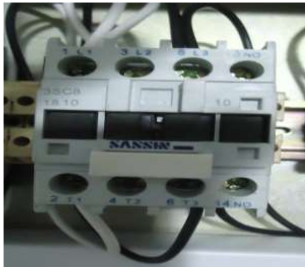
Figura 21. Foto del contactor Fuente: Foto tomada por el autor.
