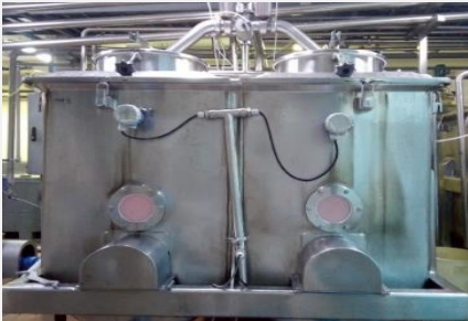
FIGURA 5. Tanque Saborización Fuente: Autor del proyecto
