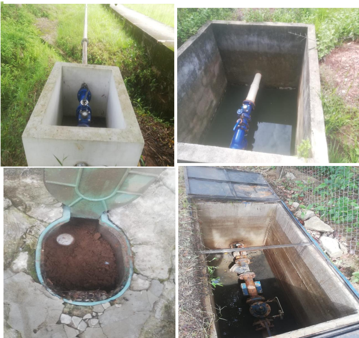
Ilustración 15. Evidencias macro medidoras en mal estado, micro medidores en mal estado
