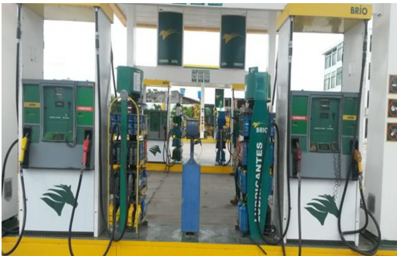
Ilustración 22. Unidad de Suministro de Combustible
