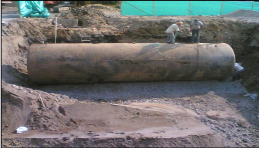
Ilustración 15. Tanque en lámina
