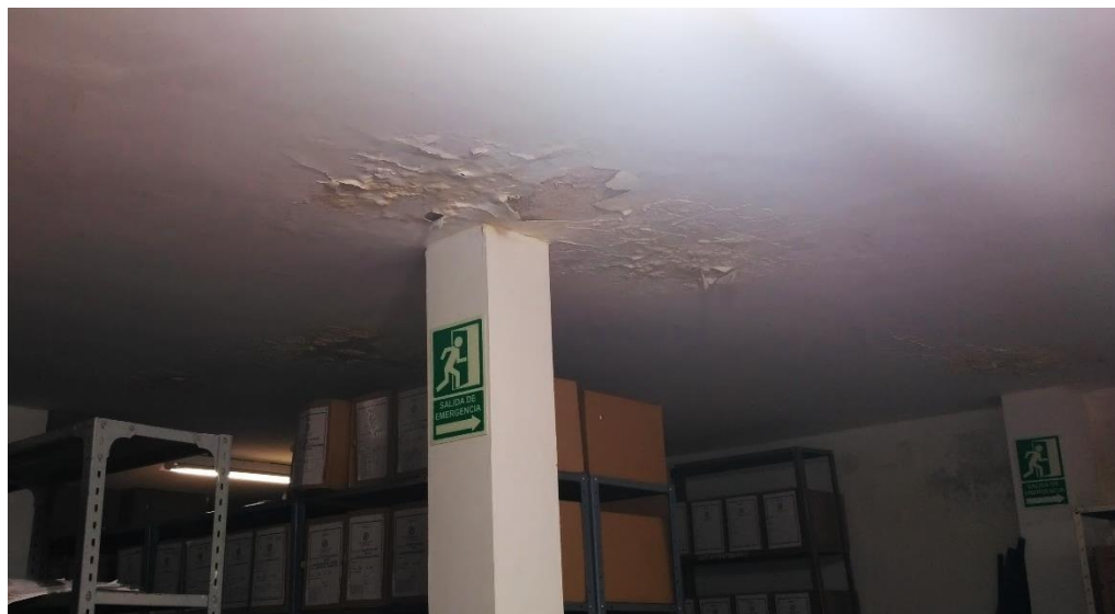
Figura 12. Fotografía – Archivo Central, techo con humedad.
