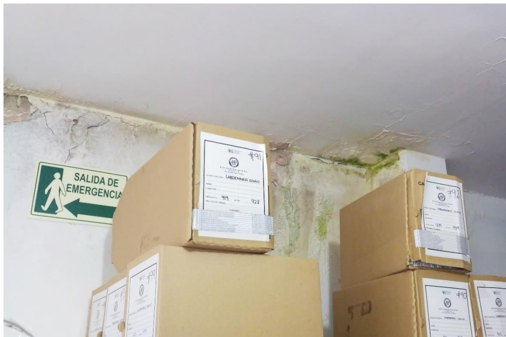
Figura 13. Fotografía – Archivo central, Archivos expuestos a la humedad.
