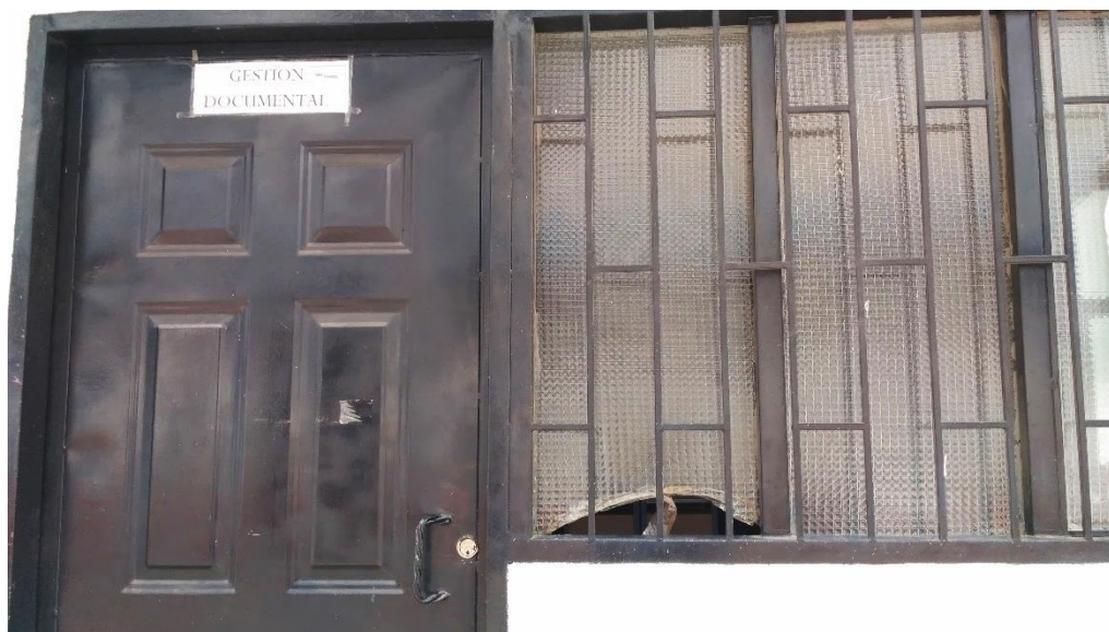
Figura 14. Fotografía – Archivo central, ventanas rotas.
