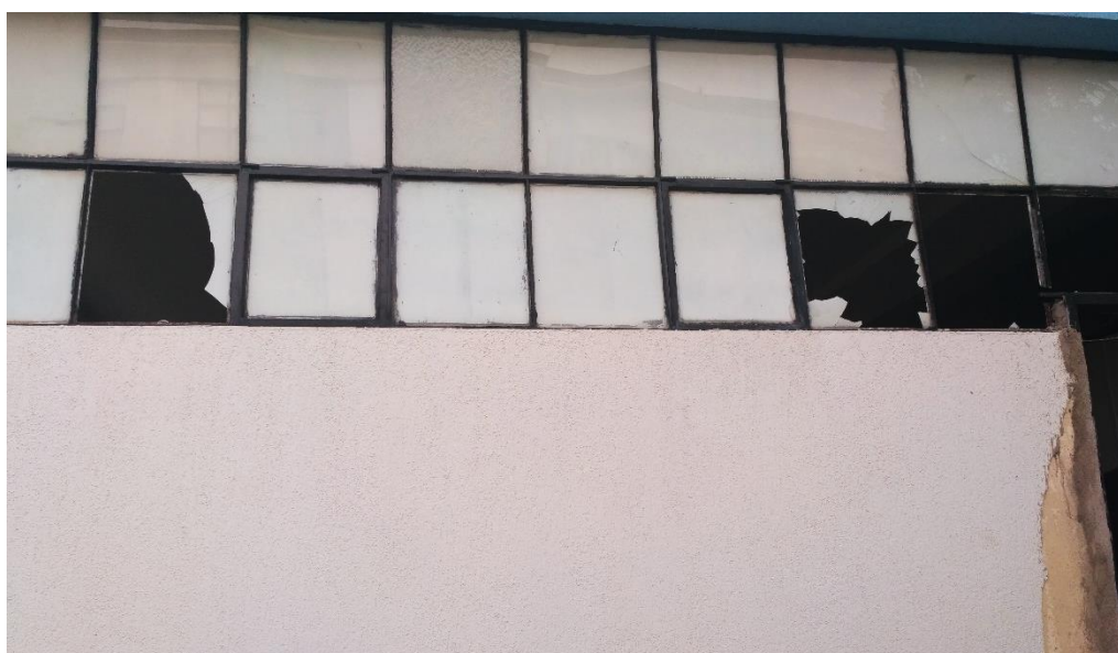
Figura 18. Fotografía – Detrás de la capilla, ventanas rotas.
