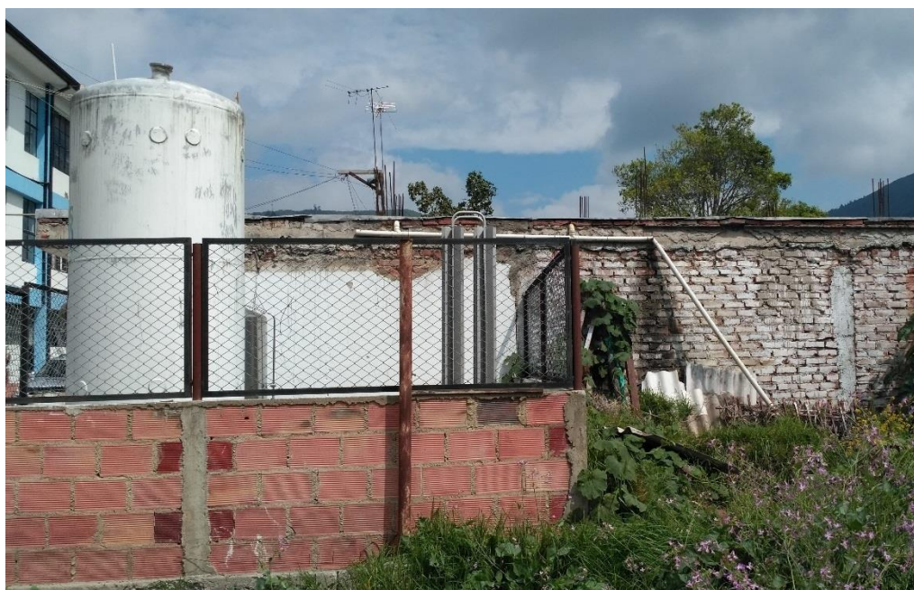
Figura 16. Fotografía – Tanque de oxígeno al lado del Archivo central.
