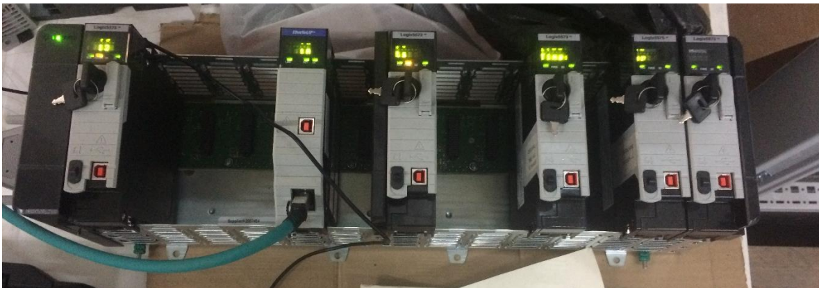
Figura 73. Rack de servidores del proceso.
