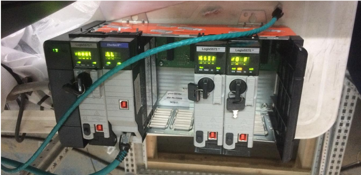
Figura 72. Rack de servidores del proceso.
