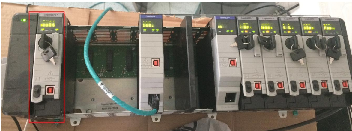
Figura 30. Controlador trabajando en chasis de 13 Slot.
