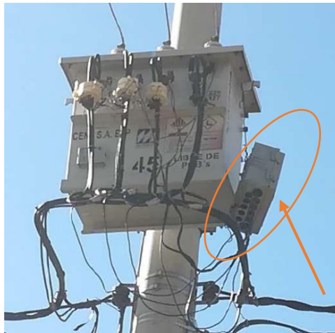
Figura 5. Analizar de red instalado en transformador
