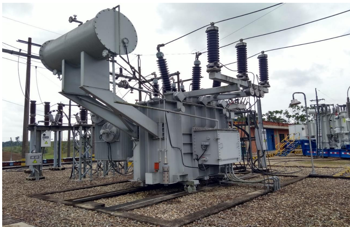
Figura 22. Transformador de potencia Siemens tridevanado TRAFOP1. Fuente EEBP.
