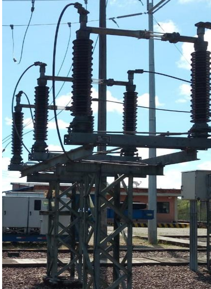
Figura 18. Seccionador de potencia giratorio de dos columnas tipo SGF subestación Puerto Caicedo 7221. Fuente EEBP.
