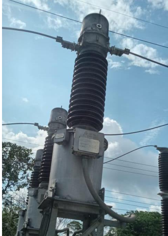
Figura 14. Transformador de corriente tipo IMB TC1. Fuente EEBP.
