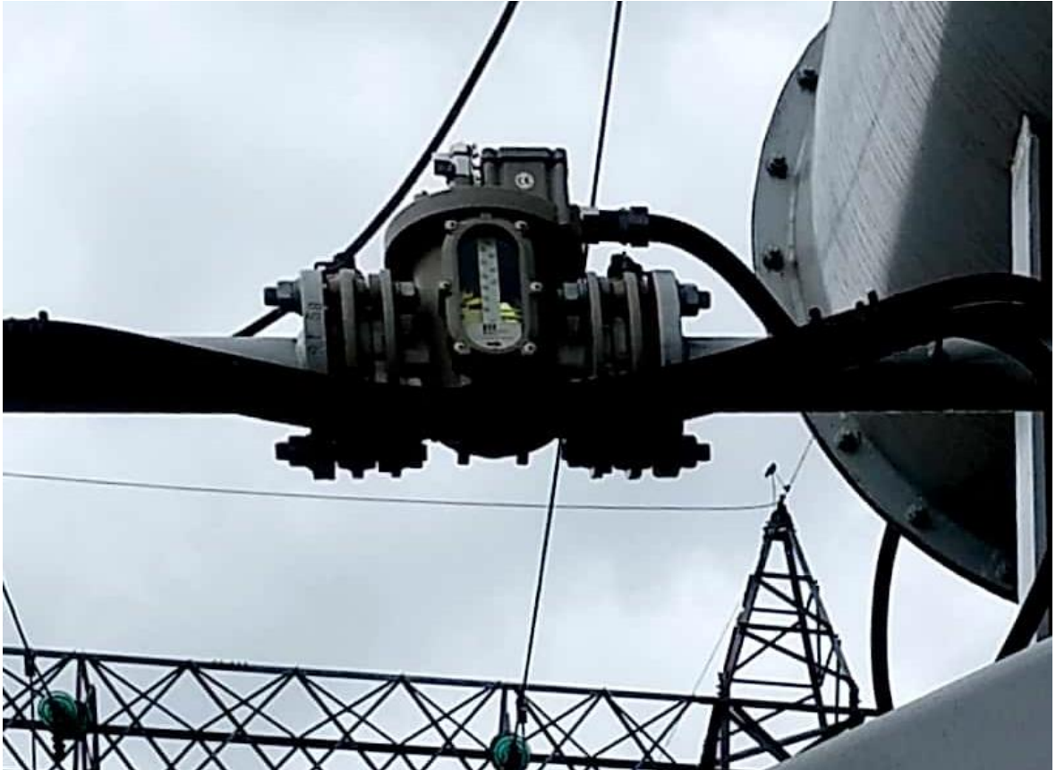
Figura 10. Relé buchholz. Fuente EEBP.
