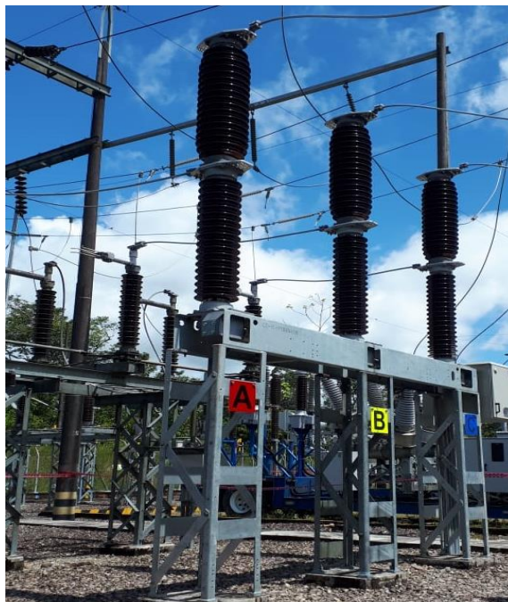
Figura 16. Interruptor automático SF6 tipo LTB montaje sobre estructura metálica INT 7220. Fuente EEBP.
