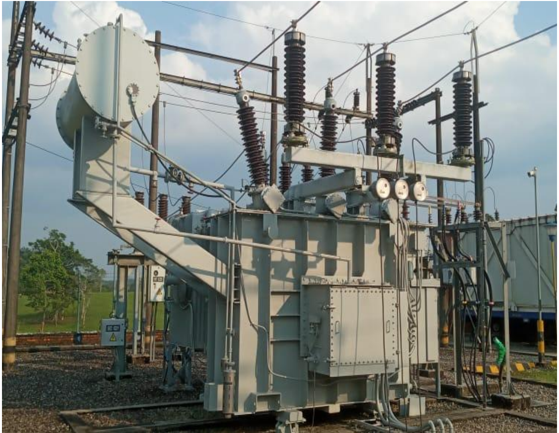
Figura 6. Transformador tridevanado Siemens de 12.5 MVA 115/34.5/13.8 Kv. TRAFOP1. Fuente EEBP.
