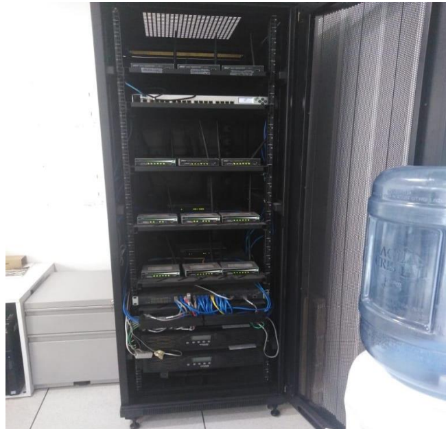
Figura 30. Módems Digi TransPort WR21 en las fronteras con los usuarios del patio de 34,5 kV
