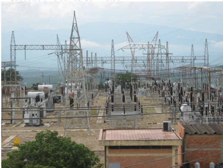
Figura 22. Subestación eléctrica San Mateo
