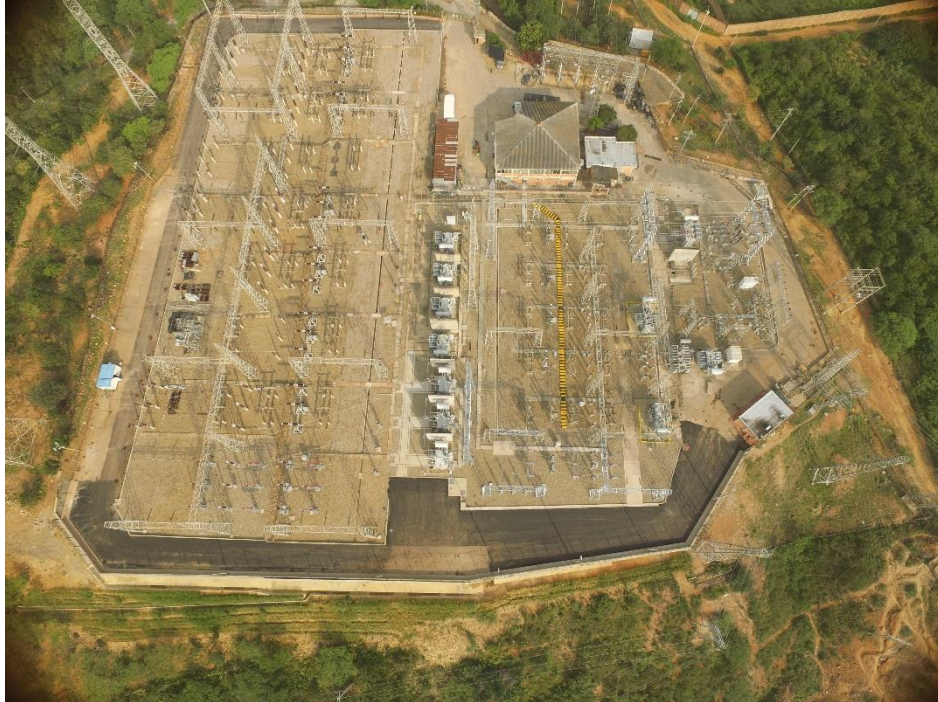
Figura 21. Panorámica de la subestación eléctrica San Mateo
