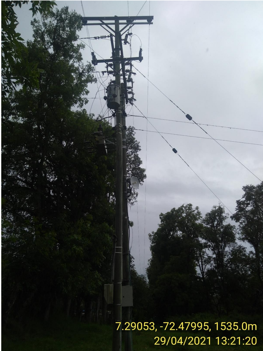
Anexo 17. Transformador Existentes que está al lado de La escuela de San Javier
