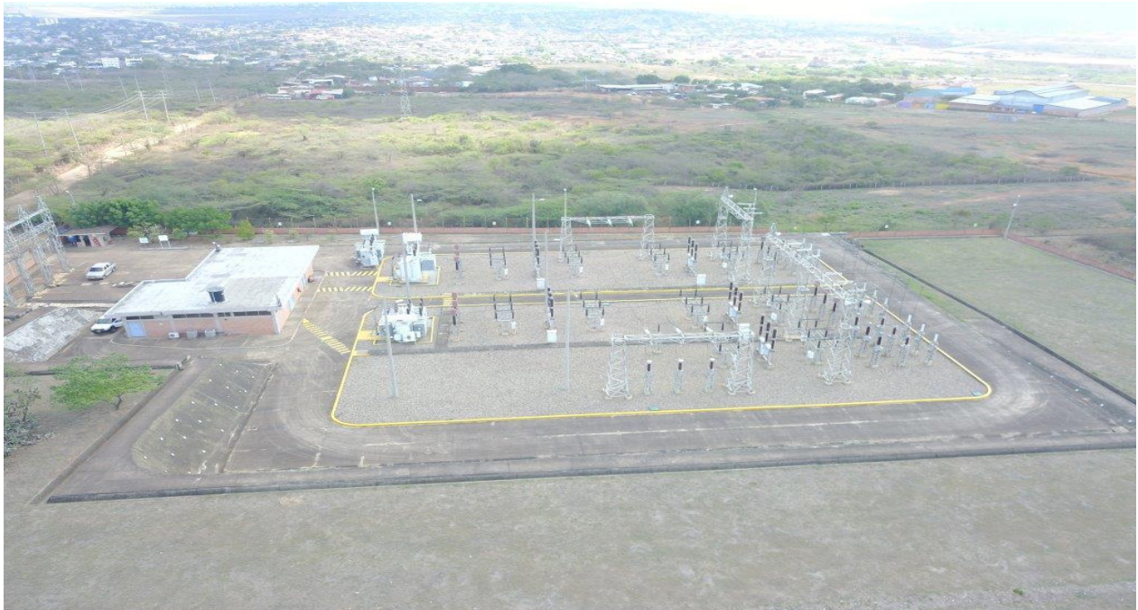
Figura 1. Panorámica de la subestación eléctrica Ínsula CENS S.A E.S.P. Fuente: (CENS E.S.P S.A, E. (2020)).
