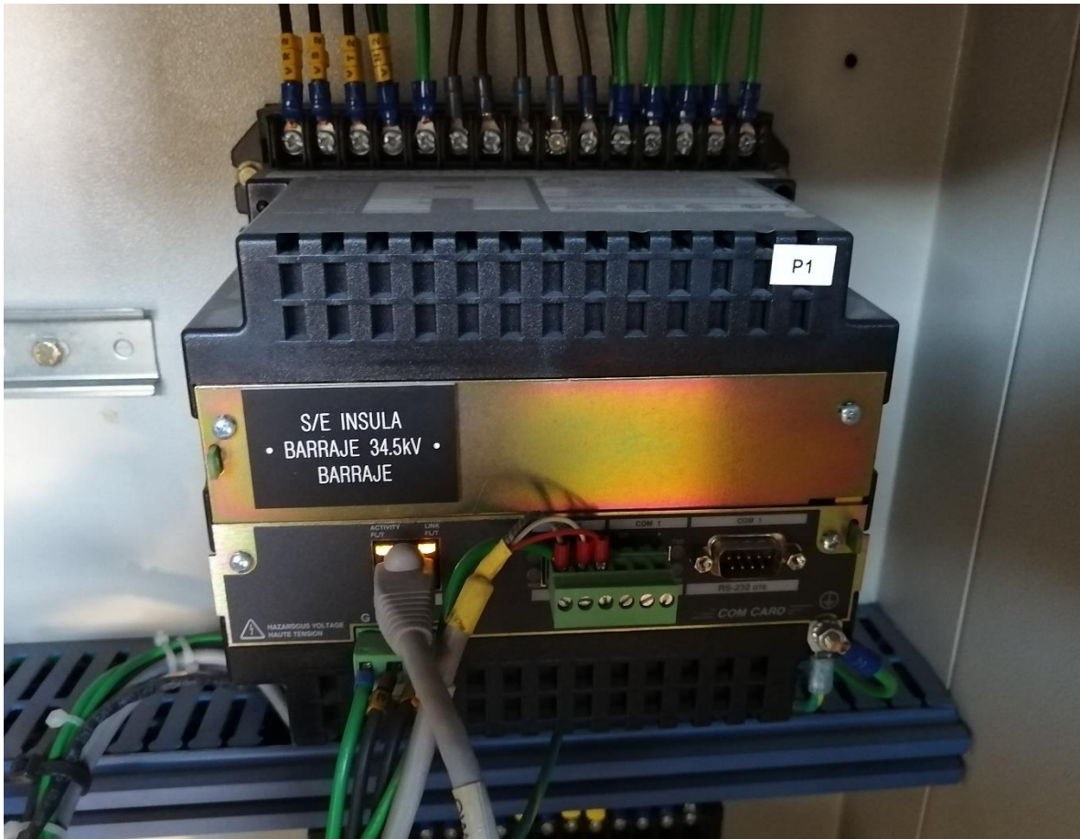
Figura 35. Analizador de red ION 7650. Fuente: CENS E.S.P S.A, E. (2020)
