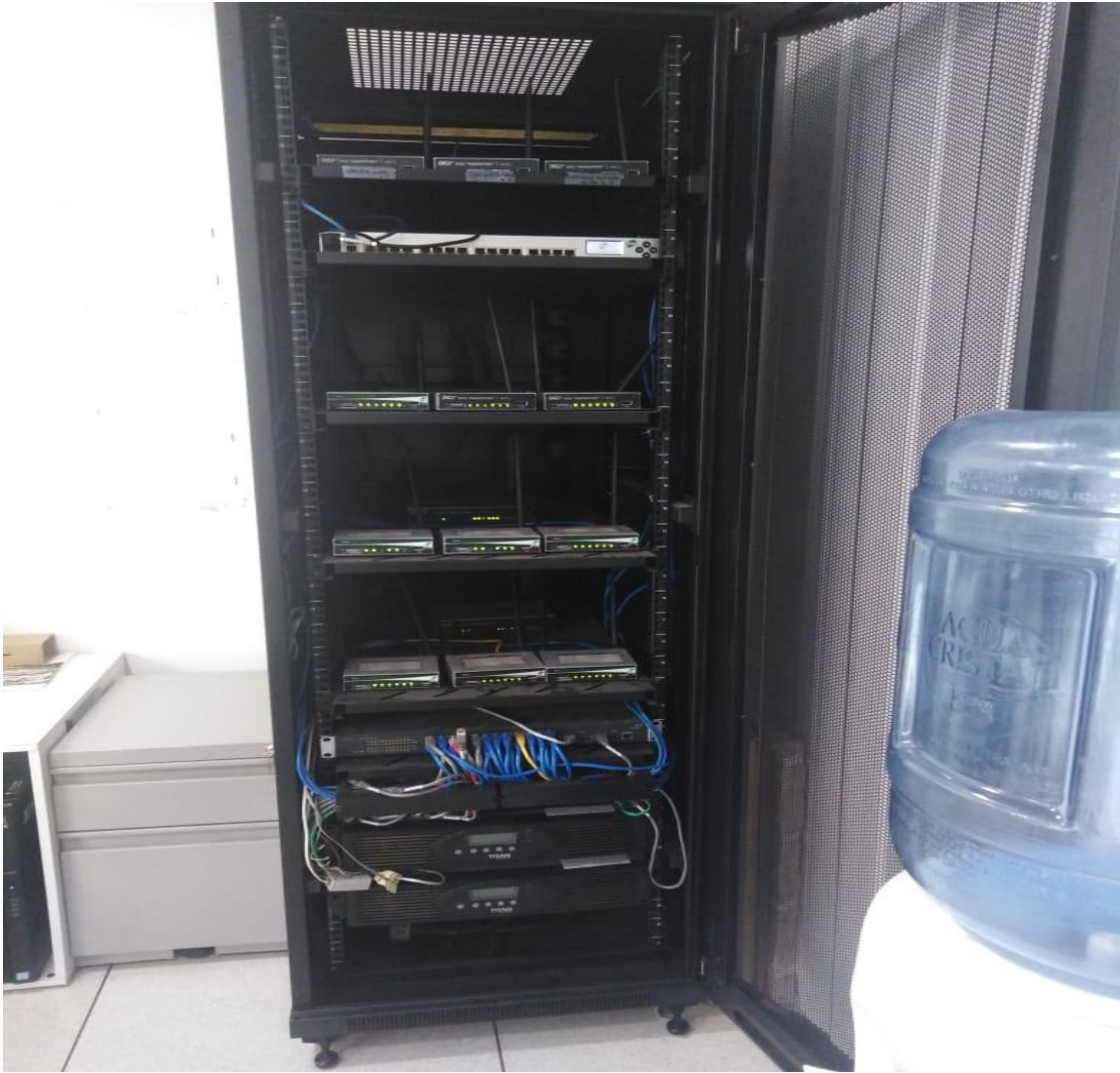
Figura 38. Modems de medición de teled medida en los usuarios del patio de 34,5 Kv de la subestación Ínsula. Fuente: CENS E.S.P S.A, E. (2020)
