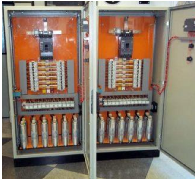
Figura 25. Banco de capacitores. [7]
