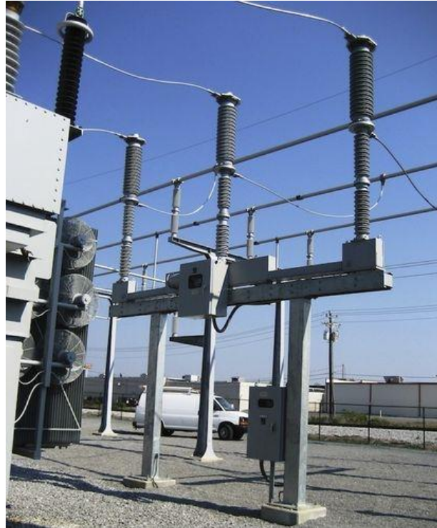
Figura 28. Seccionador de alta tensión. [28]
