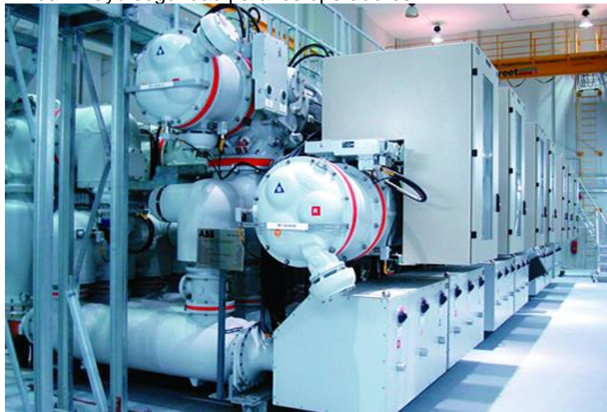
Figura 39. Subestación encapsulada de 220kV [39]
