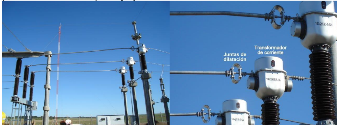
Figura 24. Transformadores de corriente. [25]
