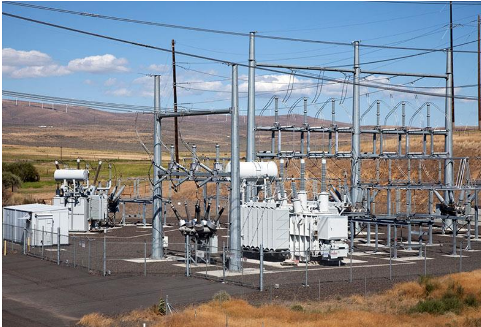
Figura 37. Subestación eléctrica tipo intemperie. [37]
