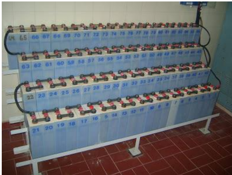
Figura 30. Banco de baterías. [30]
