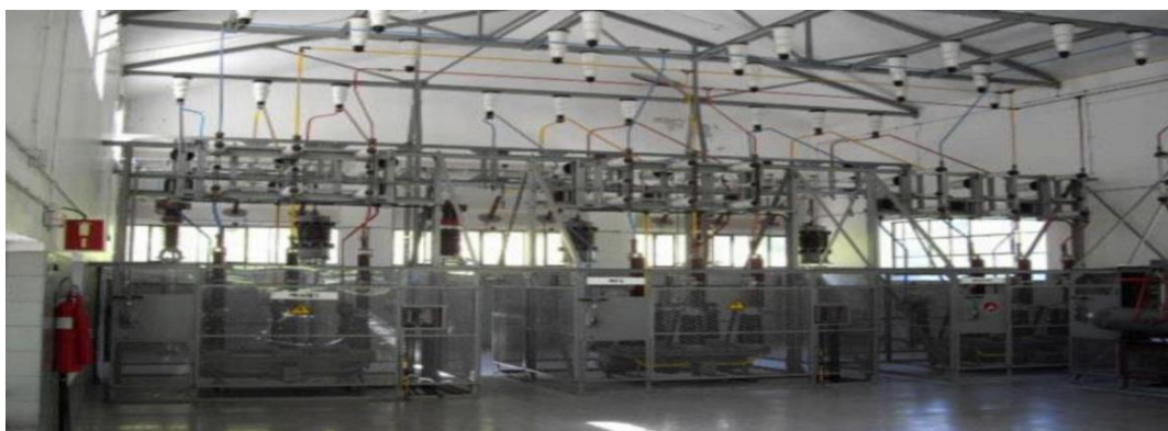
Figura 38. Subestación eléctrica tipo interior. [38]
