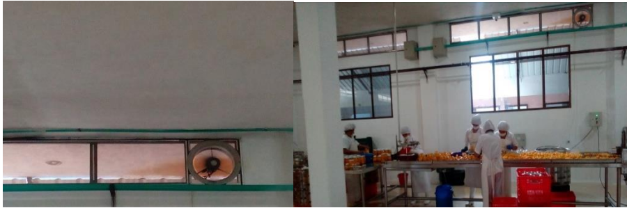
Figura 26. Extractor de aire instalado en la planta
