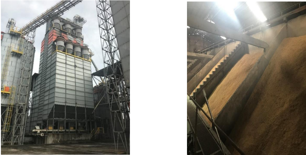
Figura 3. Torres y baterías de secamiento
