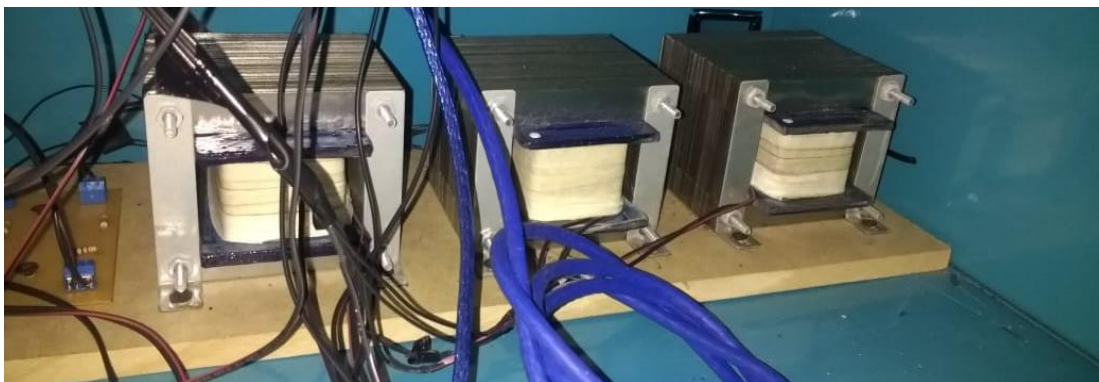
Ilustración 3. 4 Banco de transformadores Fuente: autor
