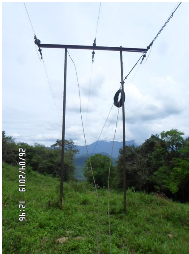
Figura 4. Postes de Riel metálico.
