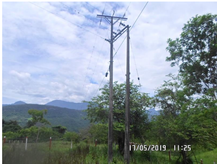
Figura 5. Postes de Concreto.
