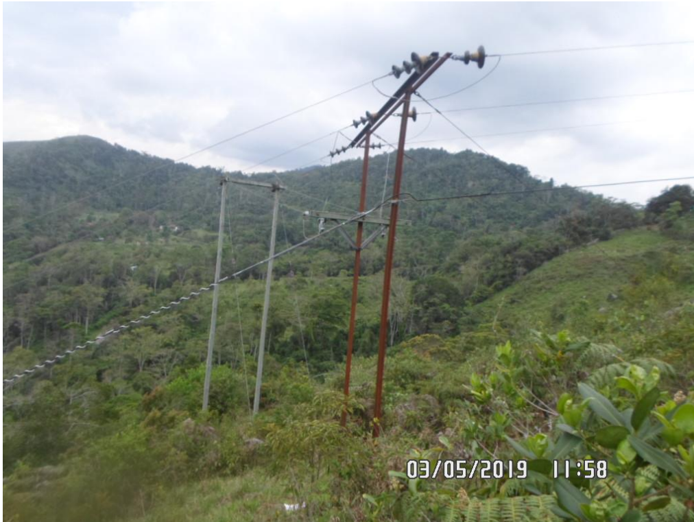
Figura 6. Postes de Madera.
