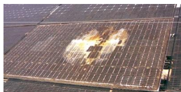
Figura 33: Destrucción de un módulo fotovoltaico debido a puntos calientes.
