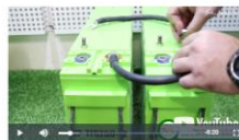
Figura 132: Conexión de baterías.
