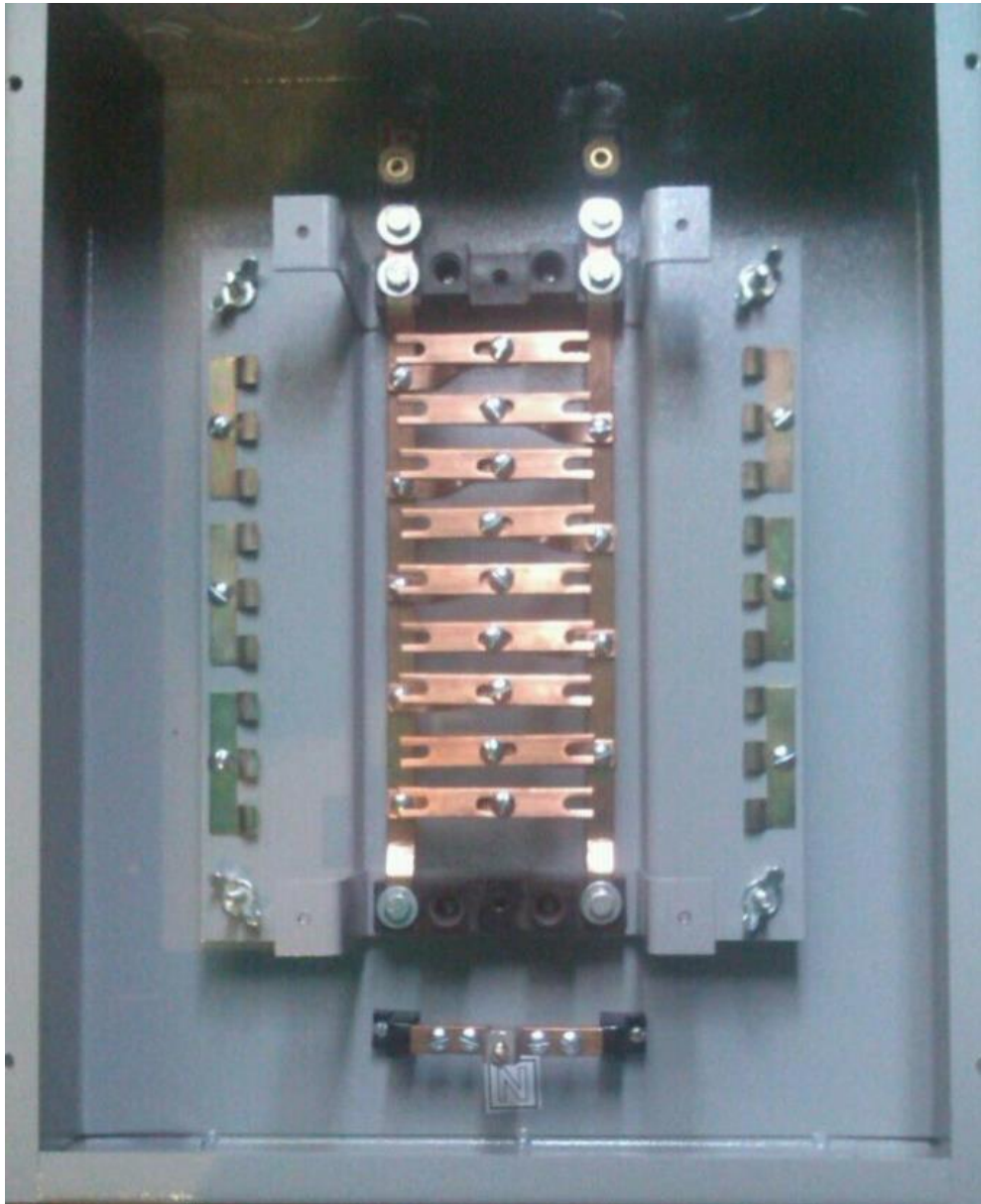
Figura 39 tablero de distribución bifásico de 18 circuitos
