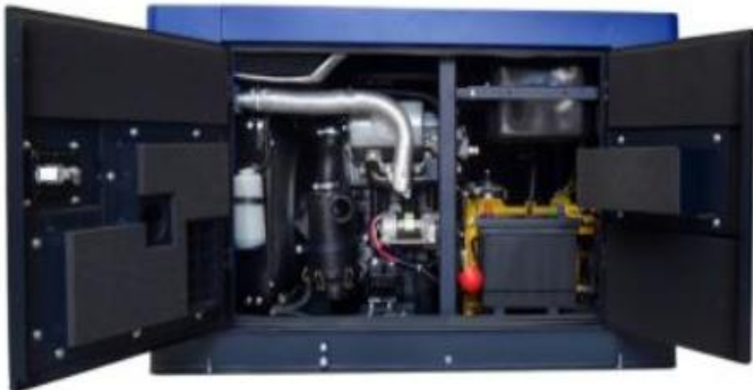
Figura 16: Motor generador de 19 KVA vista frontal puertas abiertas [26]
