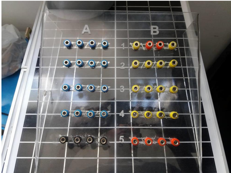
Figura 55: Tablero de conexión
