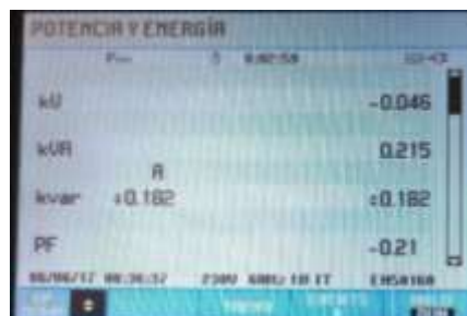
Figura 145 Parámetros de potencia y factor de potencia visualizados a través del analizador de red de marca Fluke
