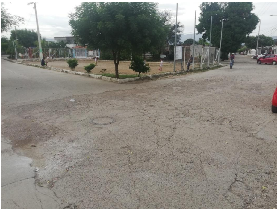
Ilustración 66 Estado de las vías
