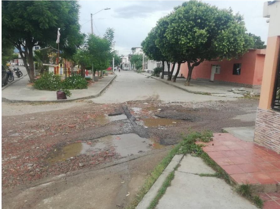
Ilustración 64 Estado de las vías
