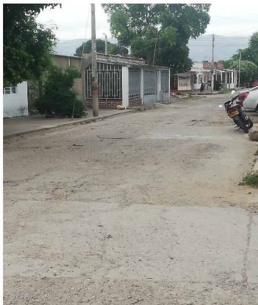
Ilustración 71 Estado de las vías
