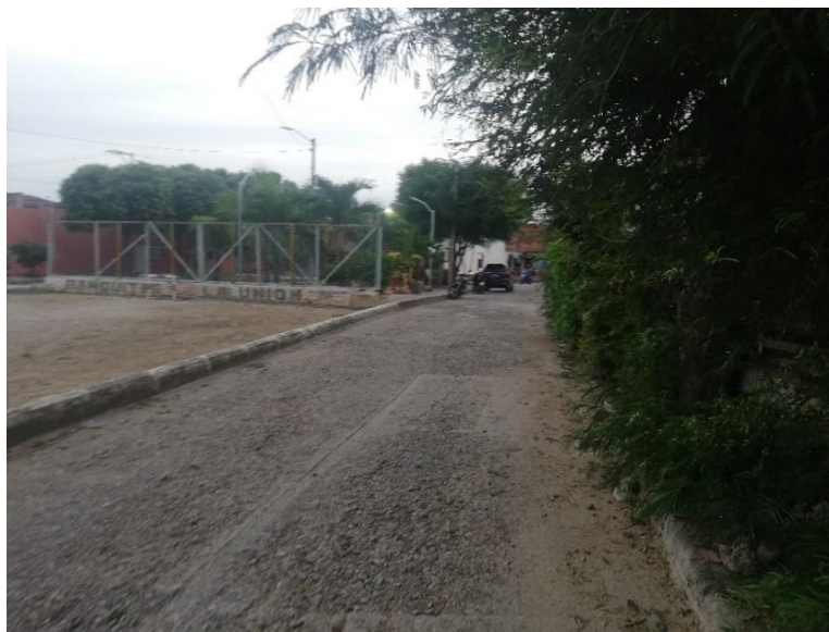
Ilustración 62 Estado de las vías
