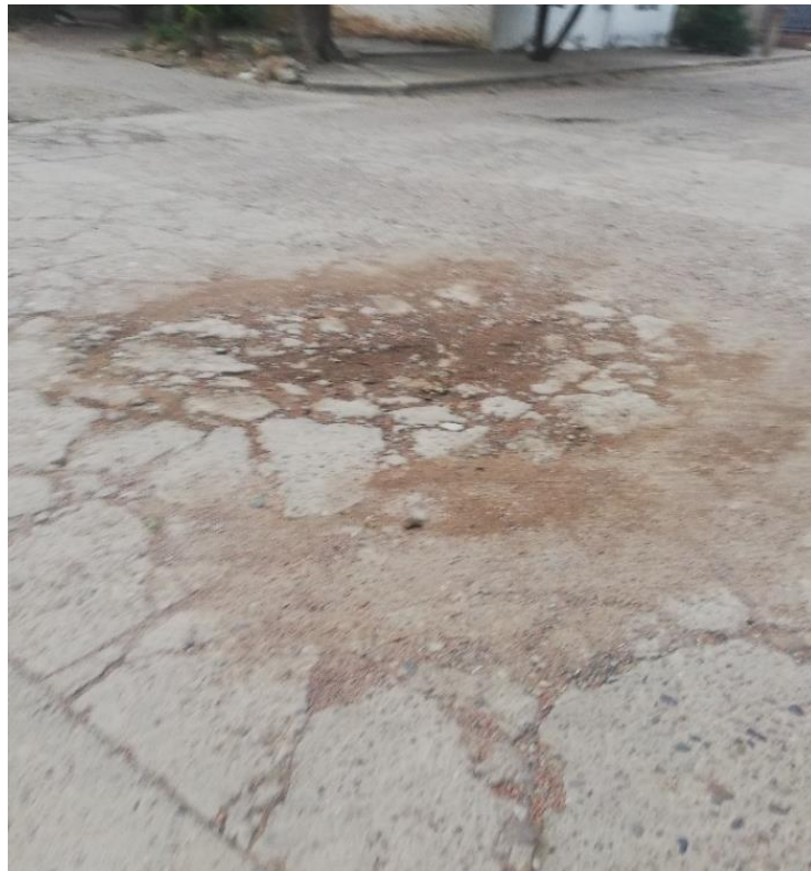
Ilustración 70 Estado de las vías
