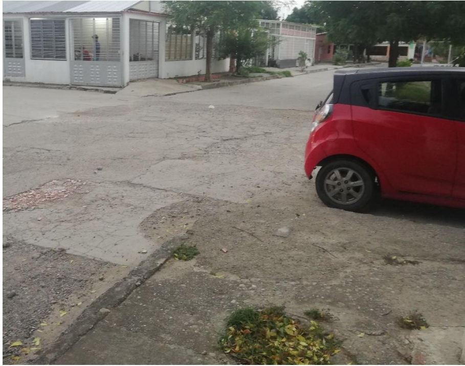
Ilustración 67 Estado de las vías
