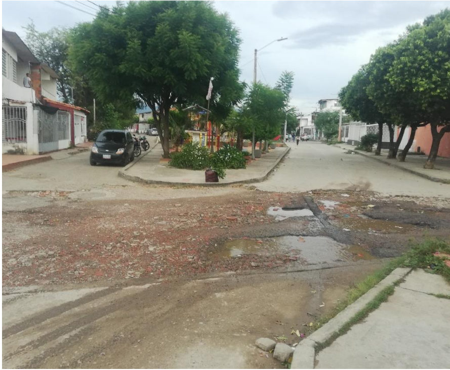
Ilustración 63 Estado de las vías
